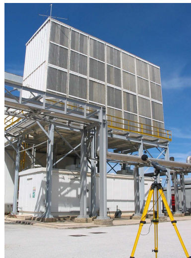
Punto I1: vista dell'air intake GR 1
