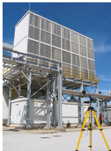
Punto I1: vista dell'air intake GR 1
