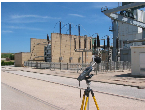
Punto I2: vista del trasformatore principale GR 1
