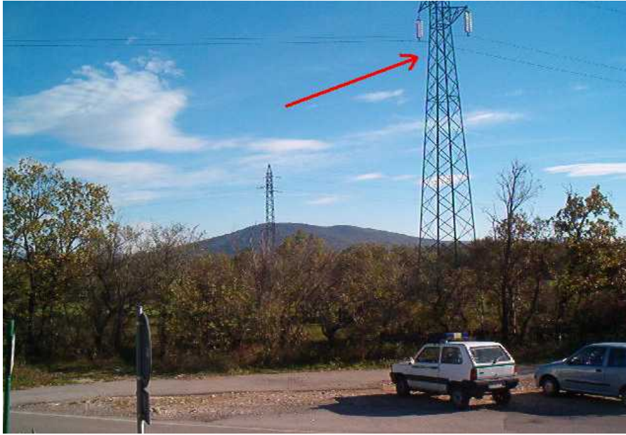
Fig. 5 – Padriciano, strada dei campi di golf – linee aeree Enel 132 kV
