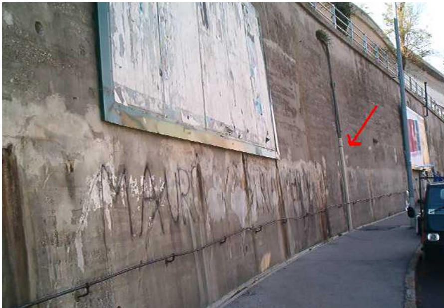
Fig. 3 – Via dell'Istria – Discesa cavi da cabina
