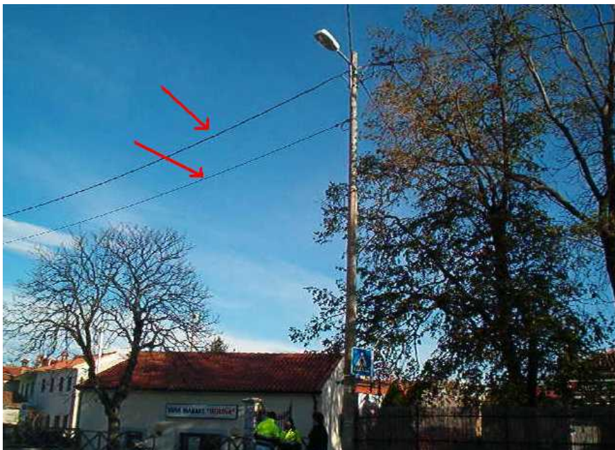
Fig. 4 – Padriciano paese – linee elettriche aeree di bassa tensione
