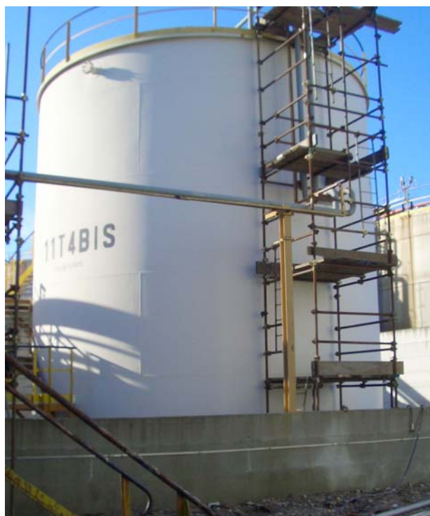
4 – Serbatoio stoccaggio acque fuori specifica
