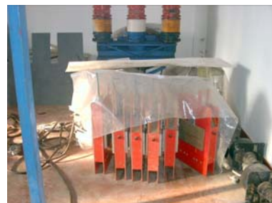
SSI10kV primo piano
