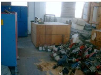
sottostazione III 30kV
