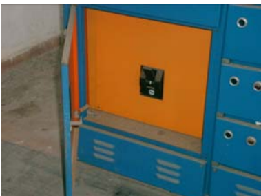
cabina 36 quadro BT tipo MCC arrivo linea sospetta presenza un interruttore SACE vedi SS III 10kv
