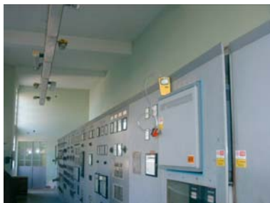
Cabina SSII10kV sala controllo lato mare piano terra al centro del locale si rileva su quadro servizi e misure in BT nr 8 interruttori SACE sospetti
