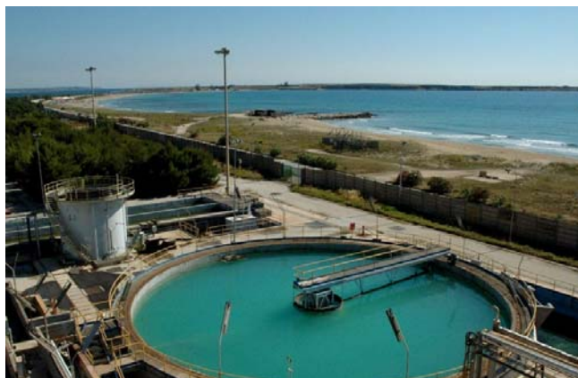
Figura 18: Impianto integrato di trattamento delle acque
