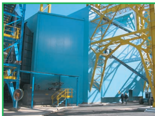
Pannellatura del diffusore di ingresso dei fumi di combustione al GVR del Gruppo 6
