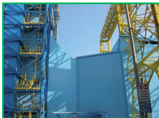
Gruppo 6: insonorizzazione del condotto di scarico del turbogas e del diffusore di ingresso dei fumi di combustione al Generatore di Vapore a Recupero (GVR)
