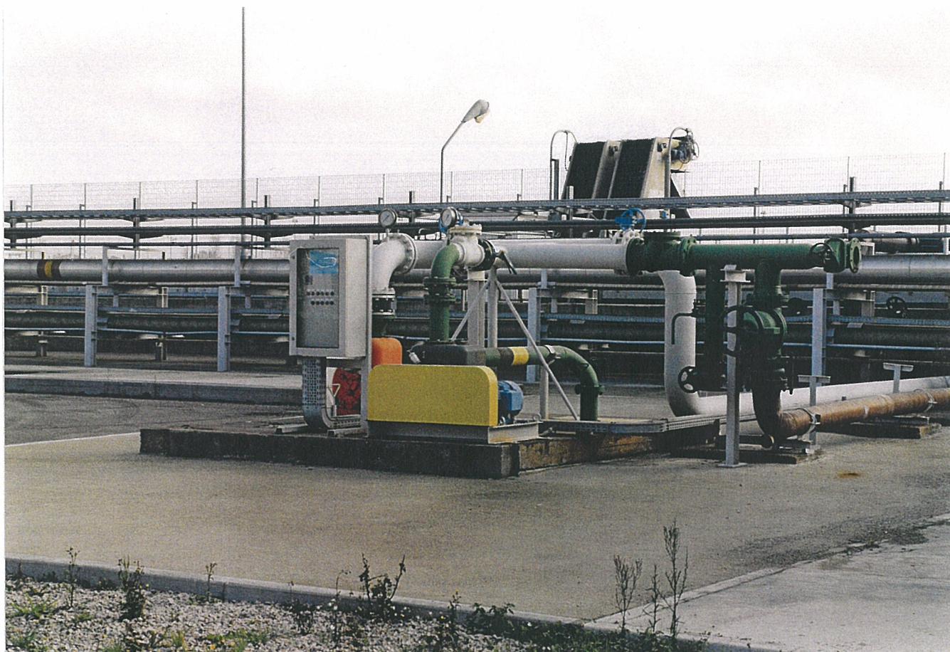
M2 – stazione di pompaggio acque meteoriche (punto centrale)
