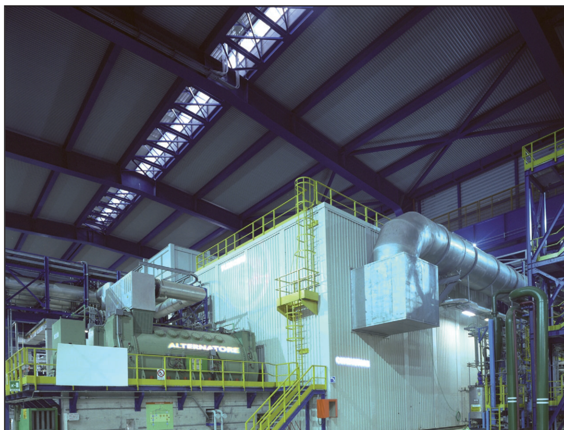
Figura n. 7 Vista della sala macchine - Gruppo turbogas- alternatore
