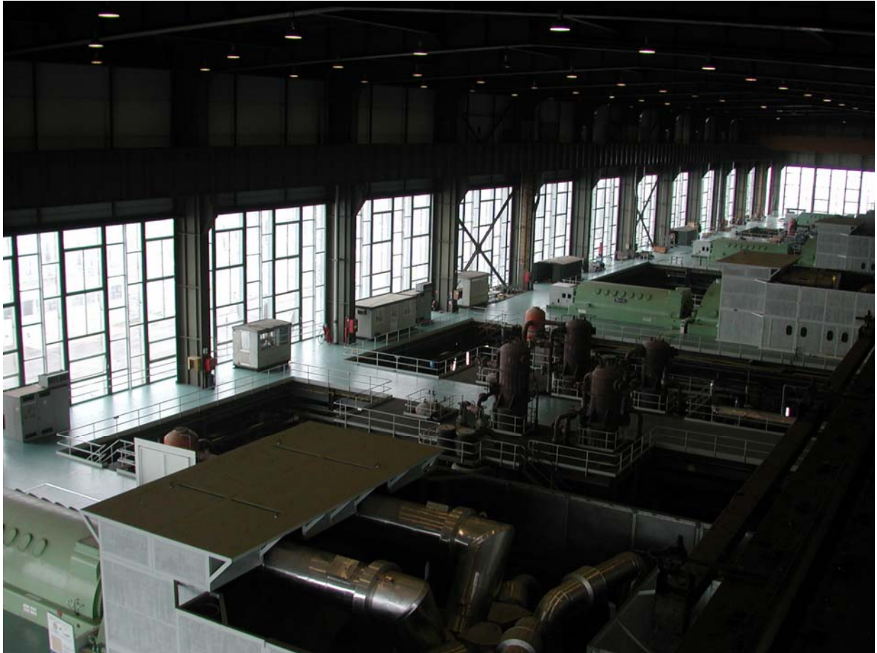
Figura 7 – La sala macchine dell'impianto di La Casella
