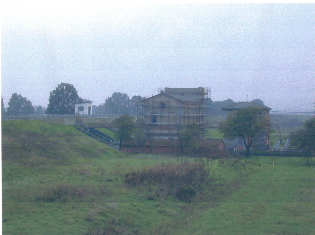
Foto 4: Impianto di sollevamento Casino dei Boschi
