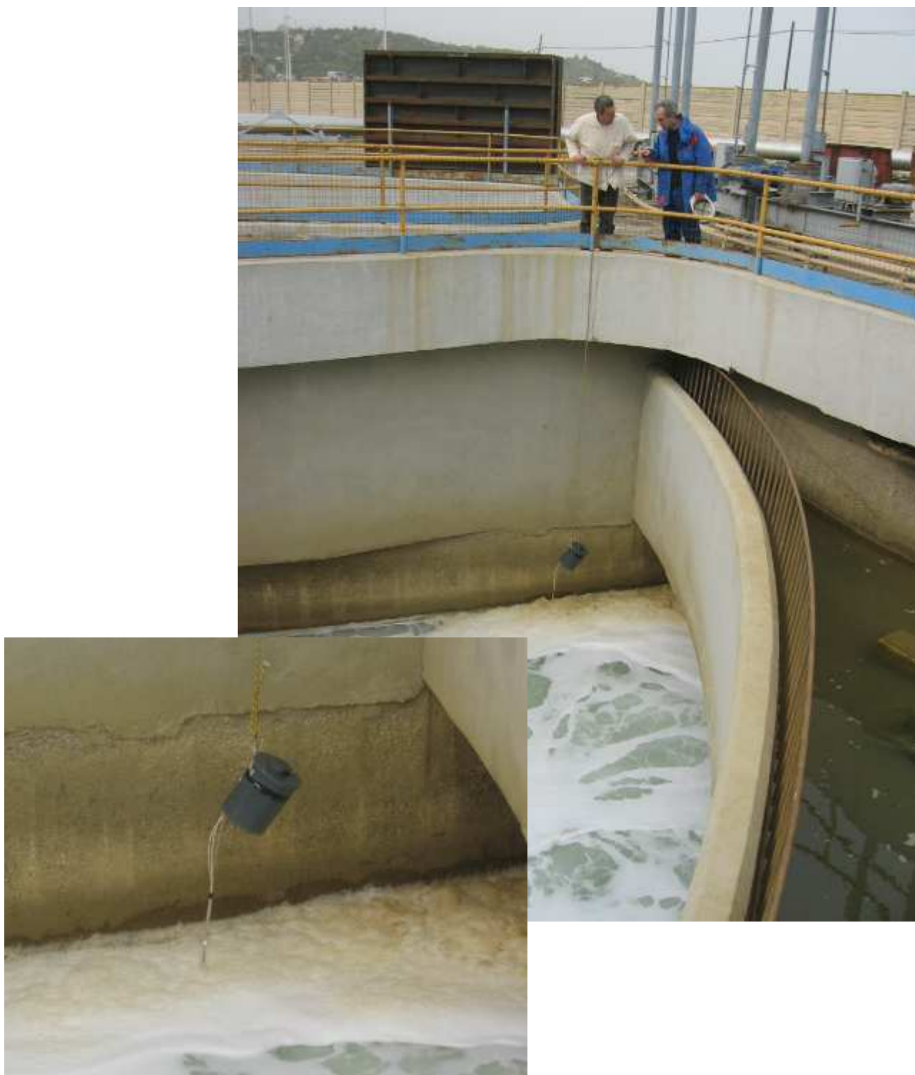
Fig.3 Installazione del termografo nella vasca di calma dell'opera di presa
