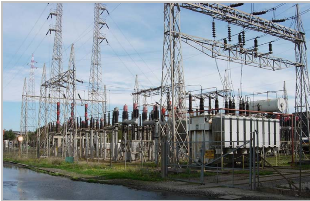
Figura 2 - Sottostazione elettrica LAM/2
