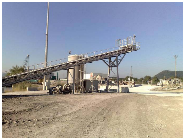
Foto n. 5 – Impianto emuref di siti similari –
