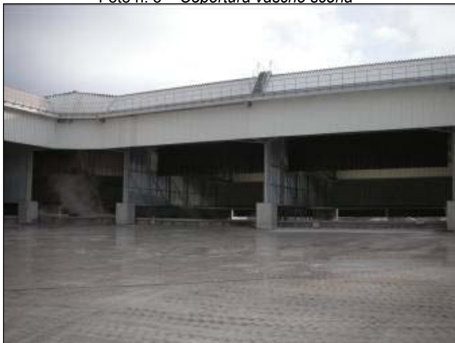
Foto n. 3 – Copertura vasche scoria –
