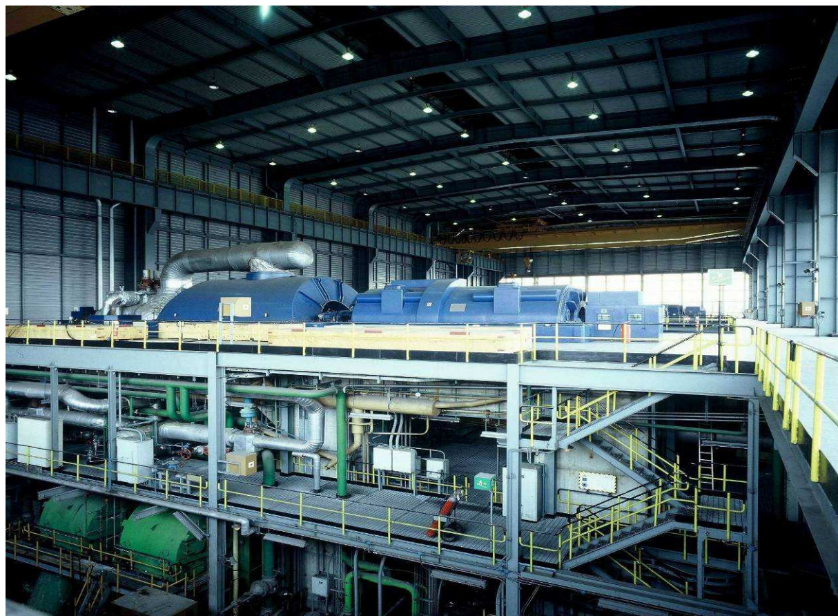
Figura 6: la sala macchine dei gruppi 3 e 4, della quale è previsto il mantenimento nel progetto di conversione
