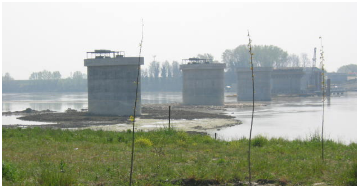
Figura 11 – Materiale di riporto alla base delle pile del nuovo ponte ferroviario a valle dello scarico (foto CESI aprile 2007)
