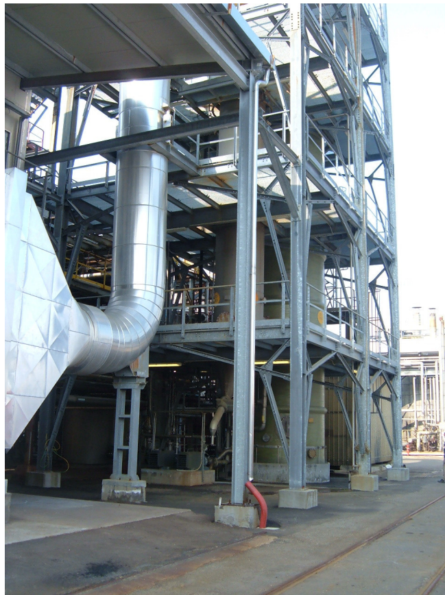
Area F: Particolare delle torri di raffreddamento e lavaggio
