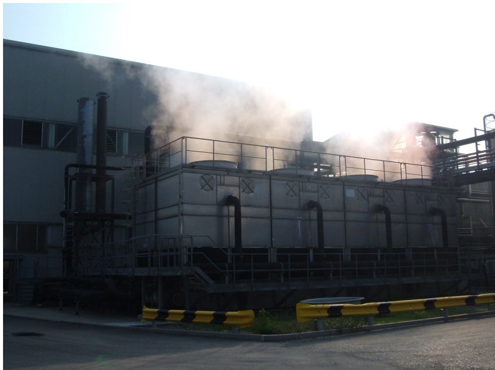
Area D: Area turbina + Torri – Particolare delle torri di raffreddamento
