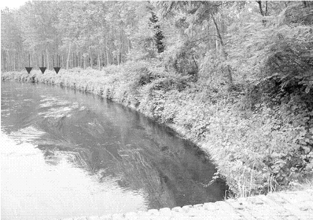
Foto 9 – Naviglio Sforzesco, punti di ancoraggio stazione SFO V
