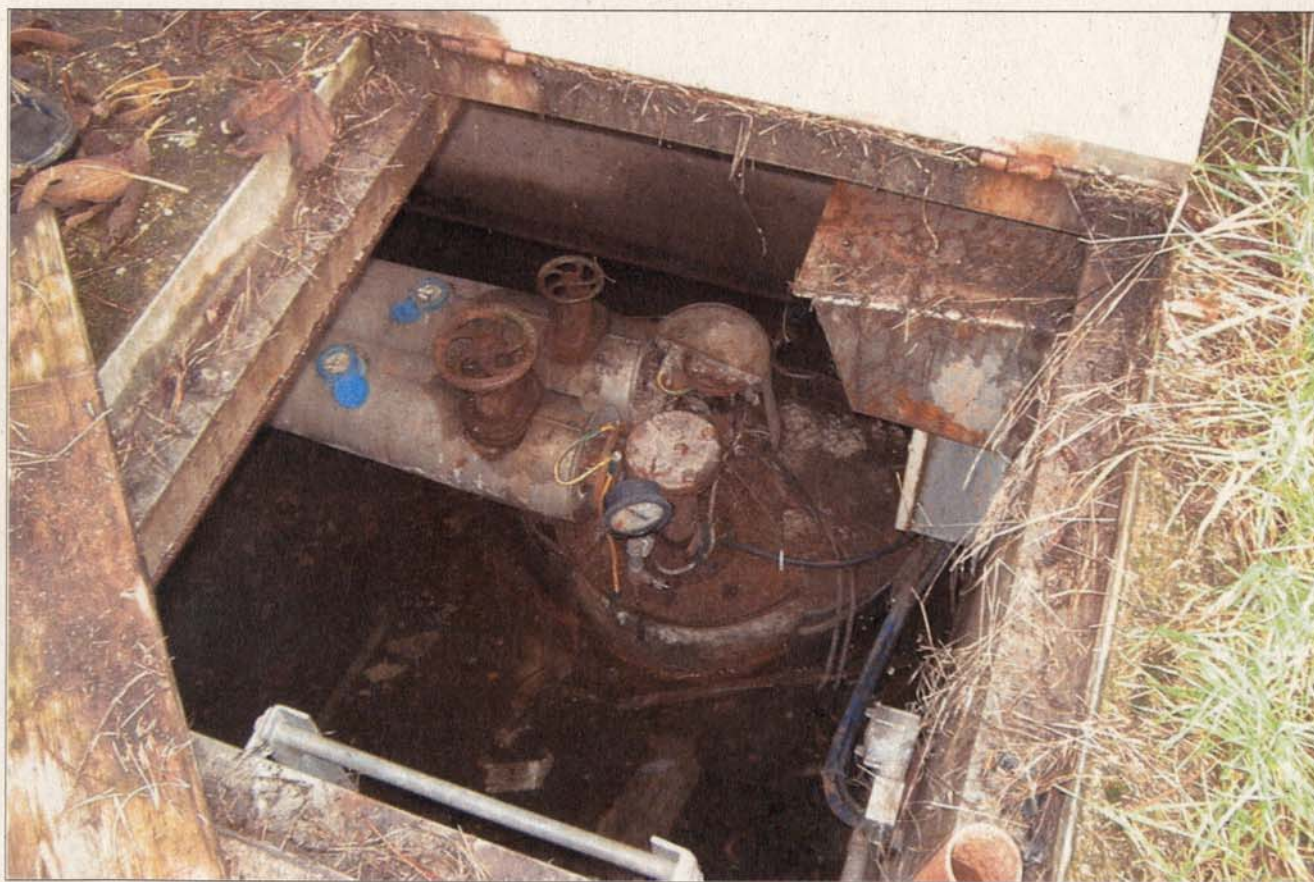
Foto n. 4 - Pozzo N. 2. Ripresa fotografica dell'avanpozzo, al cui interno sono alloggiare le n. 2 elettropompe sommerse affiancate e tutte le strumentazioni necessarie al funzionamento.
