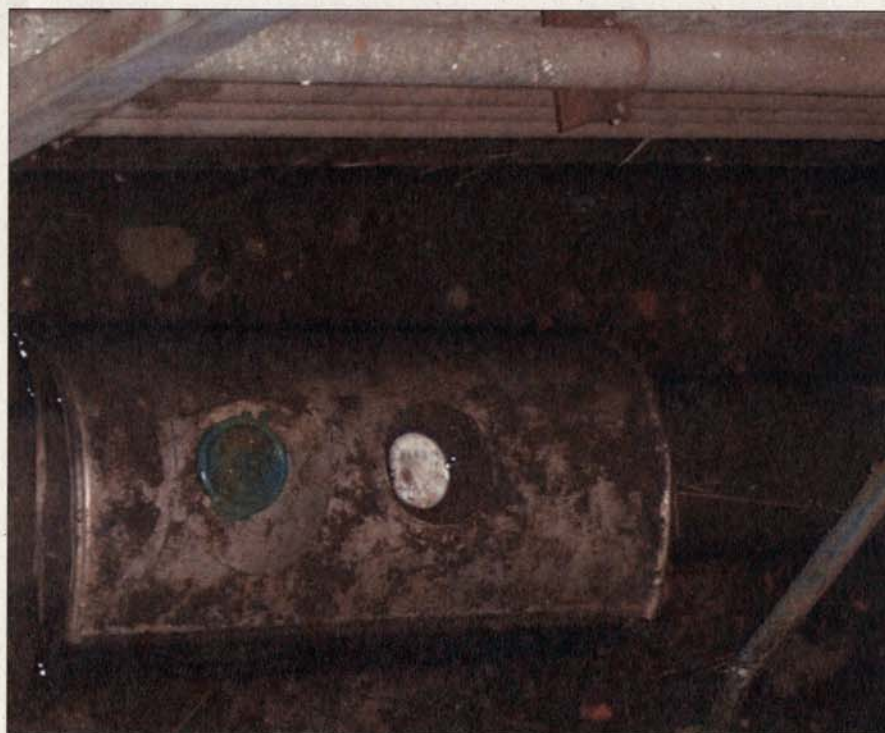
Foto n. 2 - Pozzo N. 1. Ripresa fotografica del contatore alloggiato all'interno nell'avanpozzo n. 2
