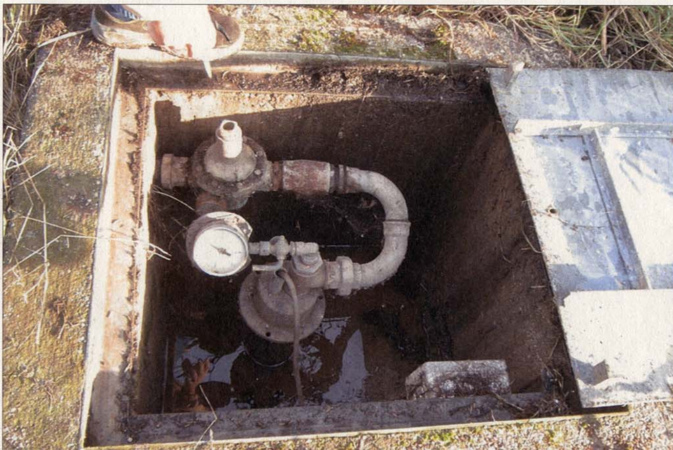
Foto n. 1 - Pozzo N. 1. Ripresa fotografica dell'avanpozzo, al cui interno sono alloggiate le strumentazioni necessarie al funzionamento.
