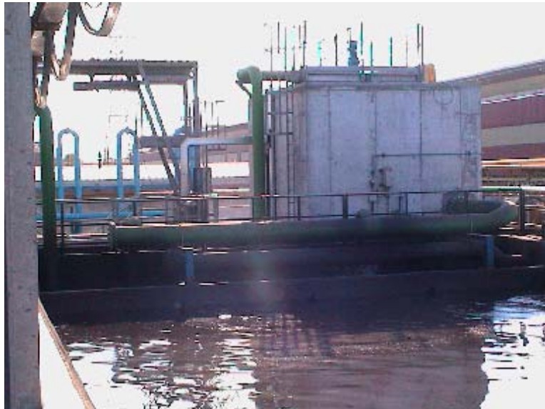
Sezione trattamento acque di controlavaggio
