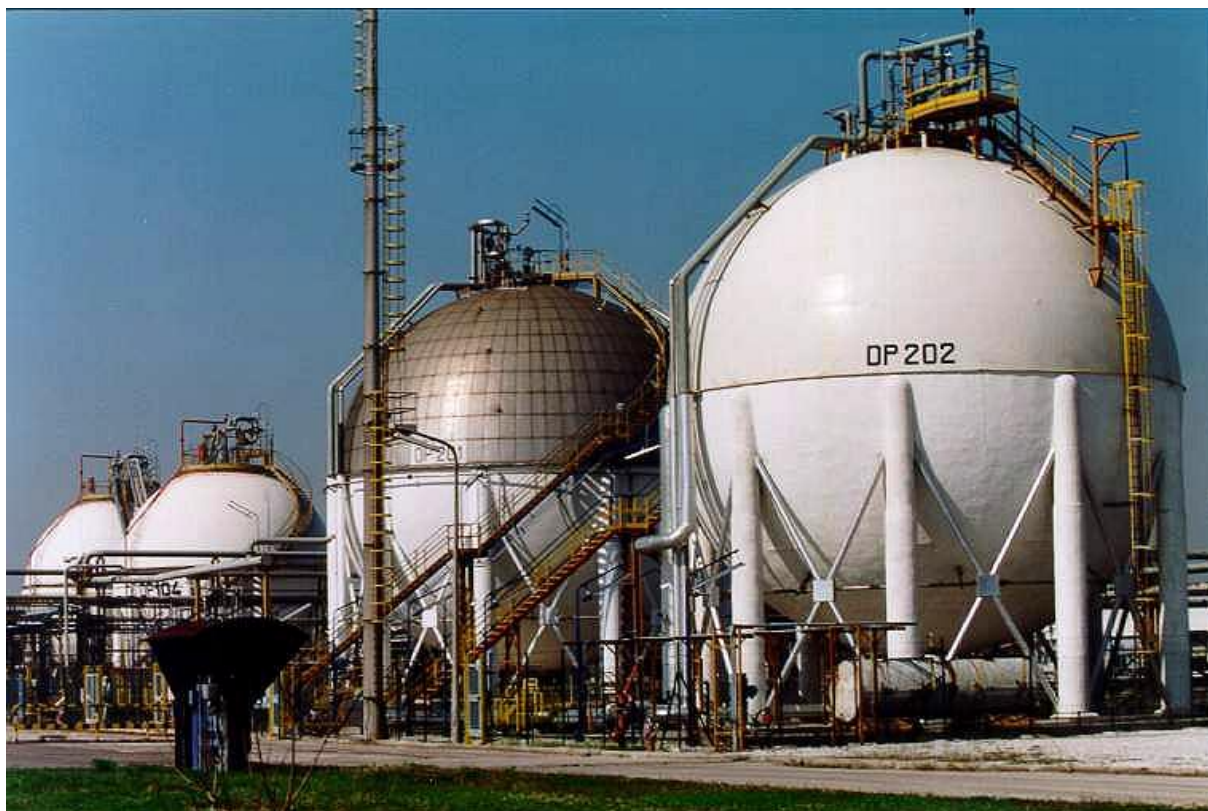
Figura 14: Serbatoi sferici di stoccaggio presso il Parco Serbatoi Ovest
