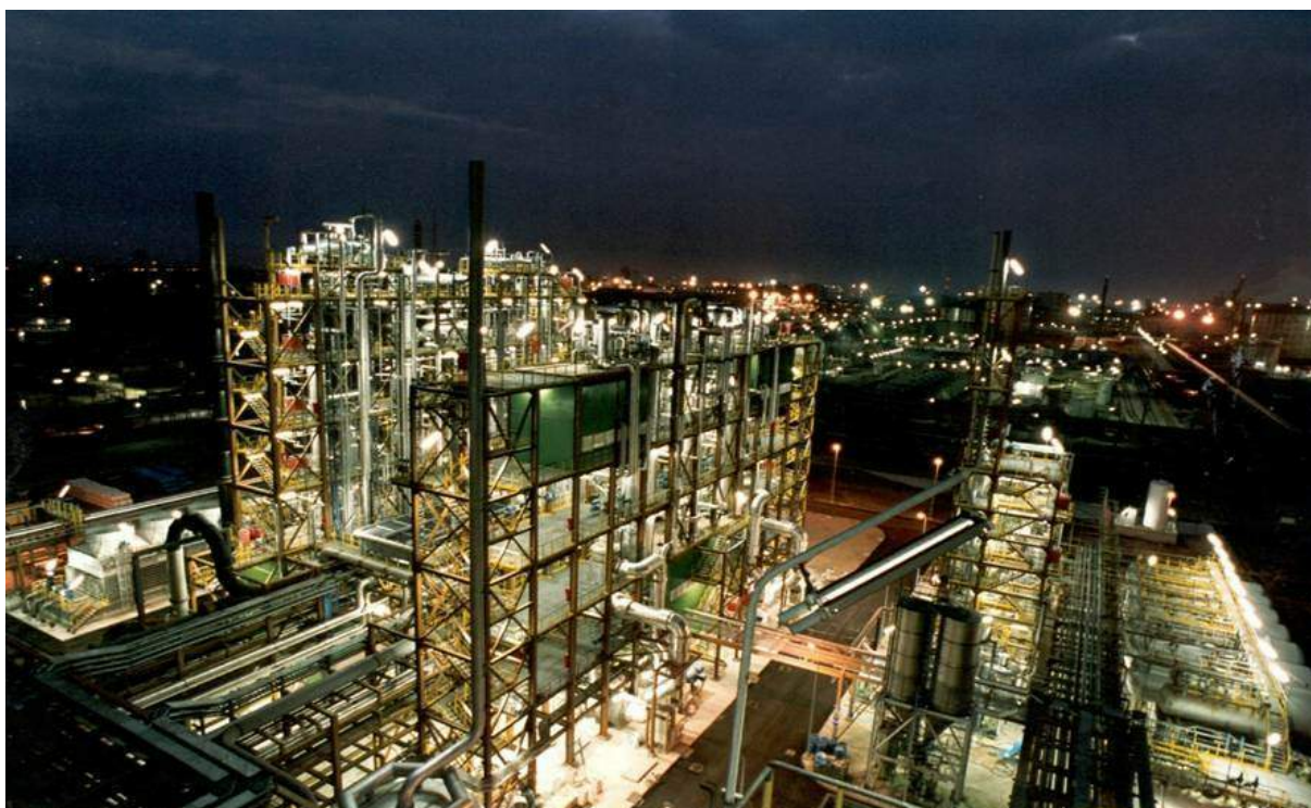
Figura 12: Impianto Meforex dello stabilimento Solvay Fluor Italia
