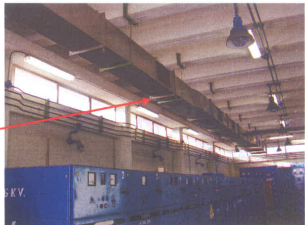
cabina 42 – guarnizioni in crisotilo
