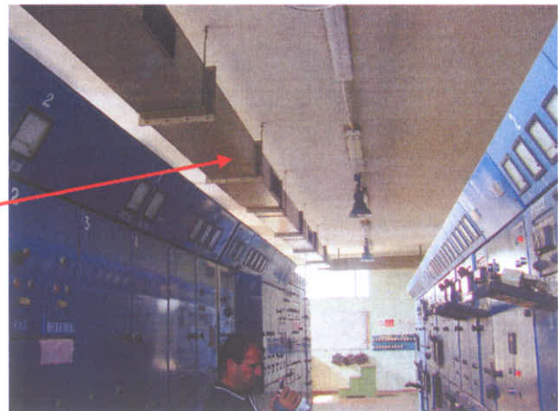
cabina 3SV – guarnizioni in crisotilo
