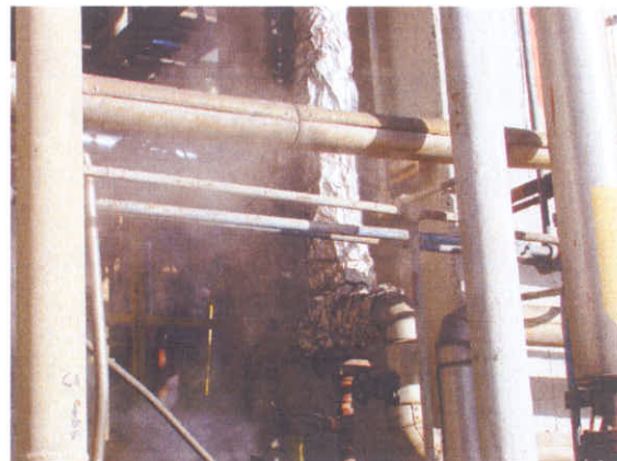
piccolo tratto di treccia in amianto nella linea di arrivo vapore ricoperto da alluminio
