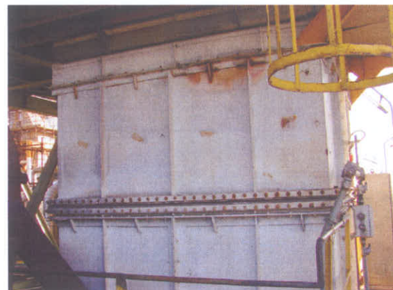
economizzatore batteria sud
