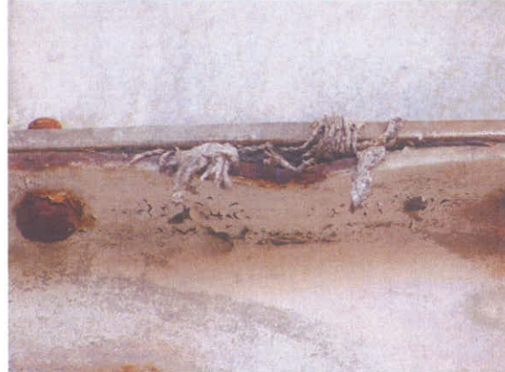
economizzatore batteria sud: guarnizione in crisotilo
