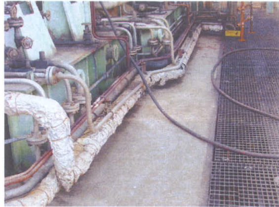
treccia di tessuto in amianto attorno alla linea di scarico olio
