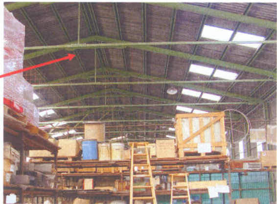
copertura in eternit
