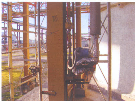
prese di livello: fettuccia in tessuto di amianto ricoperta con alluminio
