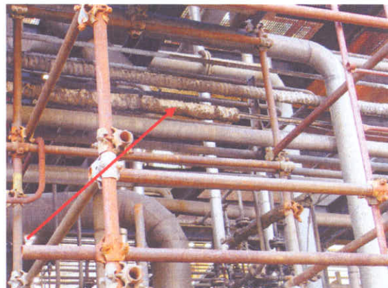
linea aerea coibentata con tessuto in amianto
