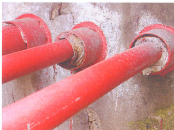
treccia di crisotilo da spessore tra mura di contenimento dei serbatoi e linee antincendio (Bacino DA 366)
