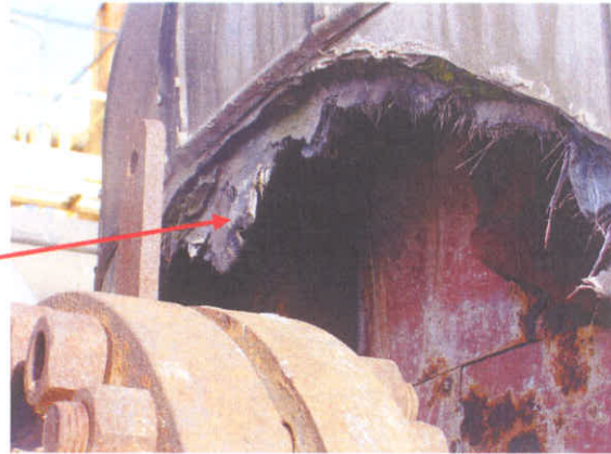
cemento amianto colonna 257Ae B
