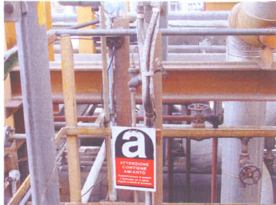
misuratore di portata linea etilene gas: fettuccia in amianto (rimossi 2 m su 30)
