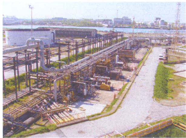
pompe e compressori
