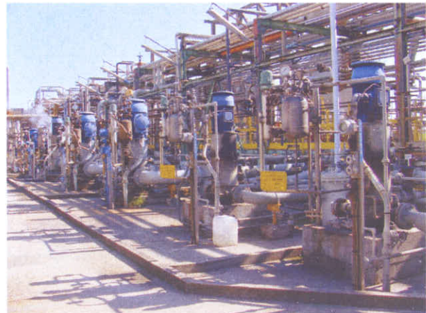
pompe e compressori: dettagli
