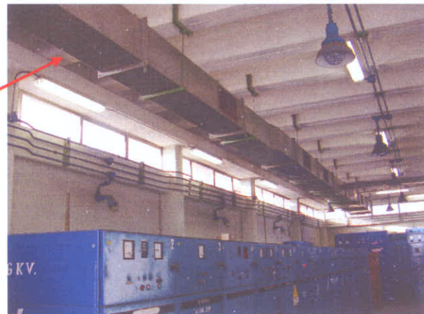
condotto aria cabina elettrica
