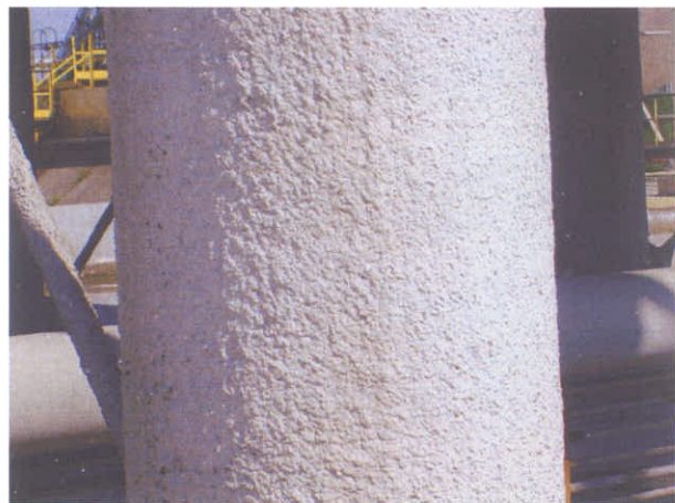
coibentazione esente da amianto
