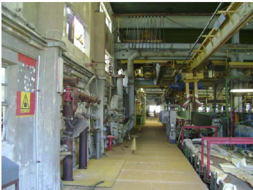
Figura 3-2: Sala celle – vista interna
