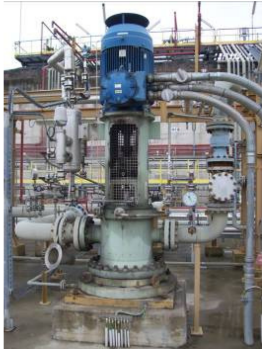
Postazione 26 – Pompe PO01 (Pompe del parco di stoccaggio monomeri) – Particolare singola pompa Il piano di calpestio è situato a 1m al di sotto del livello del terreno circostante.
