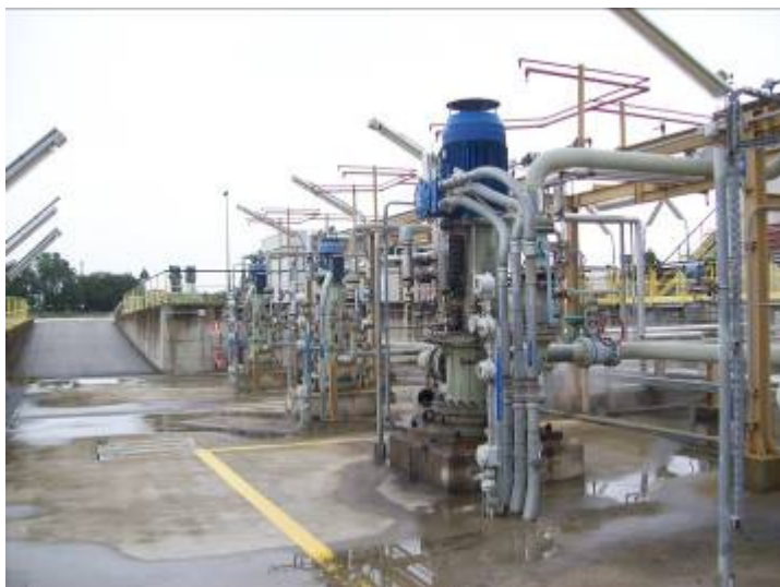
Postazione 26 – Pompe PO01 (Pompe del parco di stoccaggio monomeri) – Vista frontale, verso Nord Il piano di calpestio è situato a 1m al di sotto del livello del terreno circostante.
