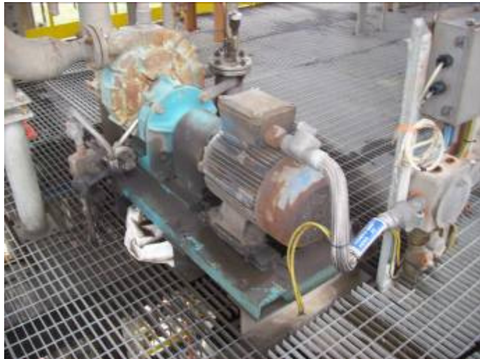
Postazione 10 – Impianto C205 (Compressore di Fluidizzazione per l'impianto T202) Il piano di calpestio è situato a 21,53m dal suolo.
