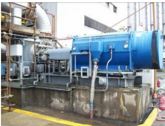
Postazione 7 – Impianto C203 di Fluidizzazione Vista Laterale
