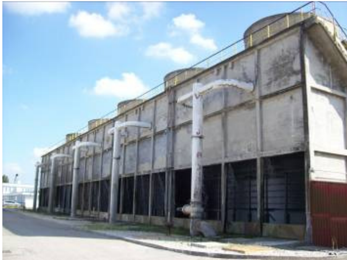
Area MPX LPG: Torri di Refrigerazione, Lato Nord
