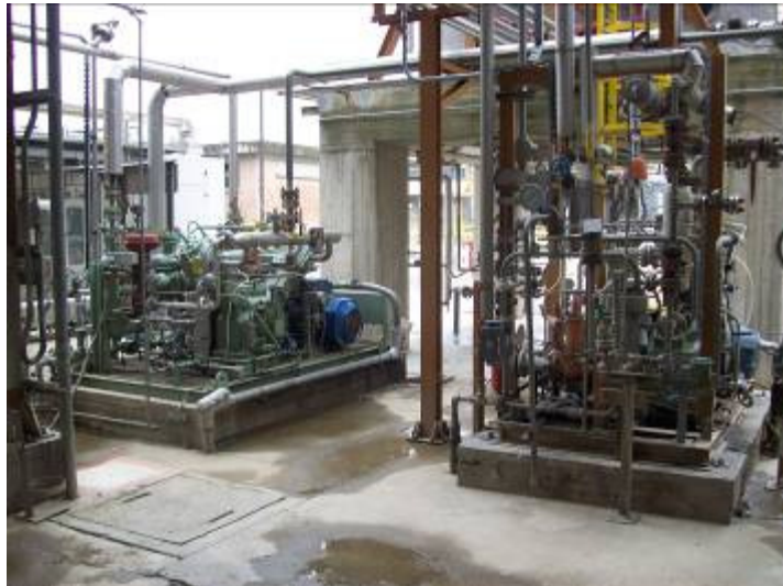
Postazione 48 – Impianti P401A e P401B (Pompe di Ricircolo Etilene verso Reattore), Vista Frontale
