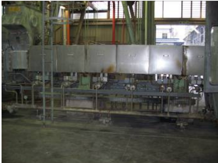
Postazione 35 – Impianto PT9001 – Coclea Estrusore
