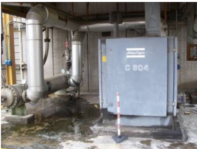
Postazione 12 – Impianto C804 (Compressore per Trasporto Polimeri) – Vista Frontale
