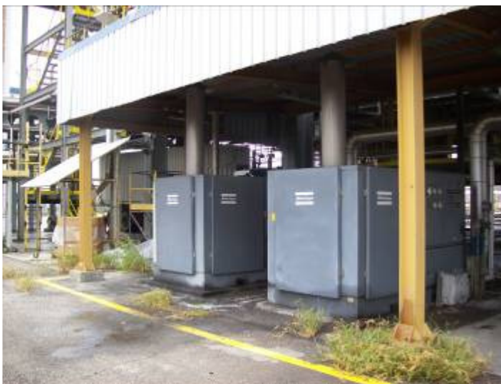
Postazione 19 – Impianti C803A e C803B (Compressori per Trasporto Polimeri) Vista Frontale
