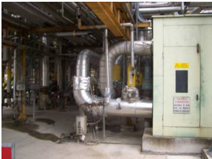
Postazione 45 – Impianto P503A (Compressore Ricircolo Azoto caldo per Essiccamento) Lato Sala Quadri
