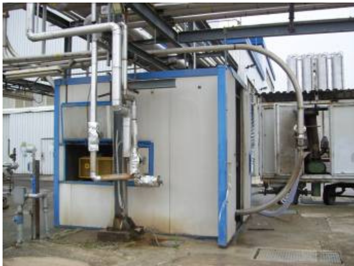
Postazione 14 – Impianto PK844 (Recupero Scarti) Vista Laterale
