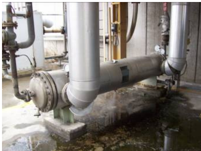
Postazione 12 – Impianto C804 (Compressore per Trasporto Polimeri) – Particolare: Scarico
