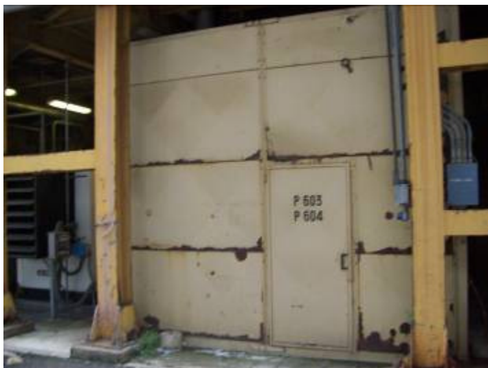
Postazione 33 – Impianti P603, P604 (Compressori Trasporto Polimeri all'interno della Sileria 500m 3 )
