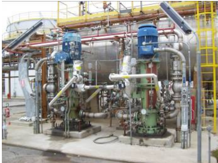
Postazione 50 – Impianti G415B e G415C (Pompe di Trasporto Polipropilene Liquido), Vista Frontale
