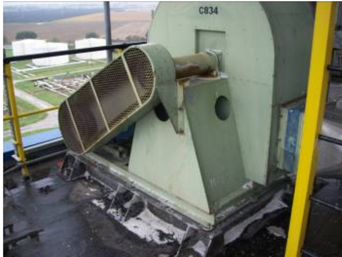
Postazione 17 – Impianto C834 (Captazione Polveri Siletti Estrusione) – Particolare Il piano di calpestio dell'impianto è situato a 31,2m dal suolo
