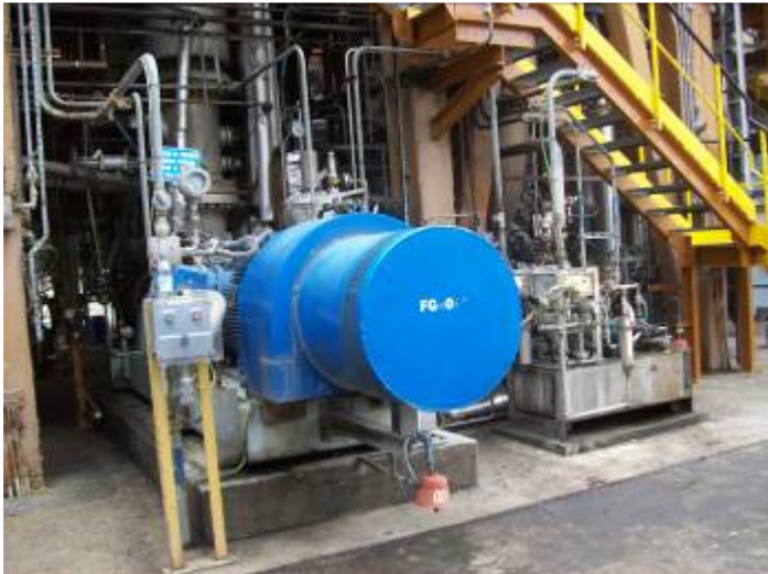
Postazione 47 – Impianto FG409A (Pompe di Ricircolo Propilene Liquido nei reattori)
