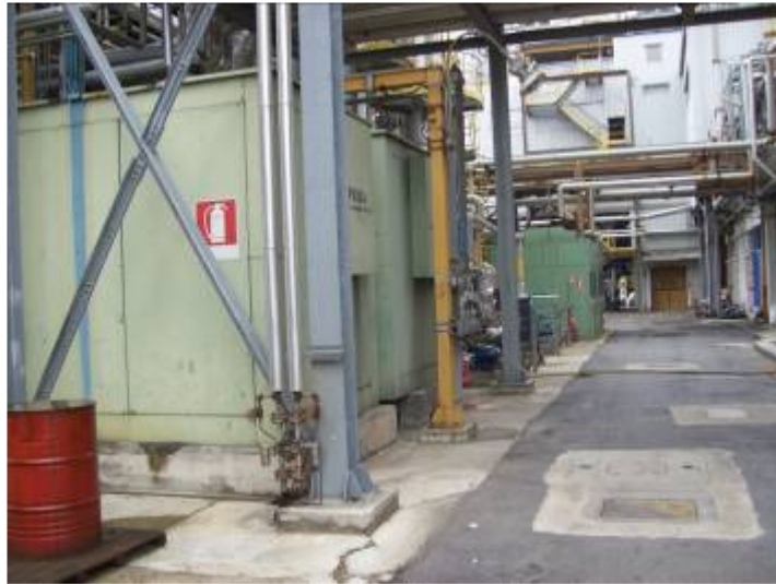
Postazione 44 – Impianto P503A (Compressore Ricircolo Azoto caldo per Essiccamento) Lato clyrell
