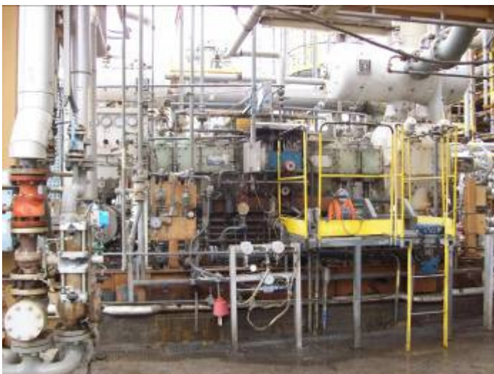
Postazione 2 – Impianto C303 (Compressore di Recupero Gas) Vista Frontale
