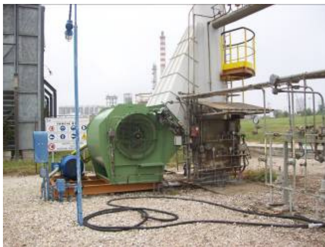
Postazione 53 – Ventilatore Torcia, Particolare: Base
