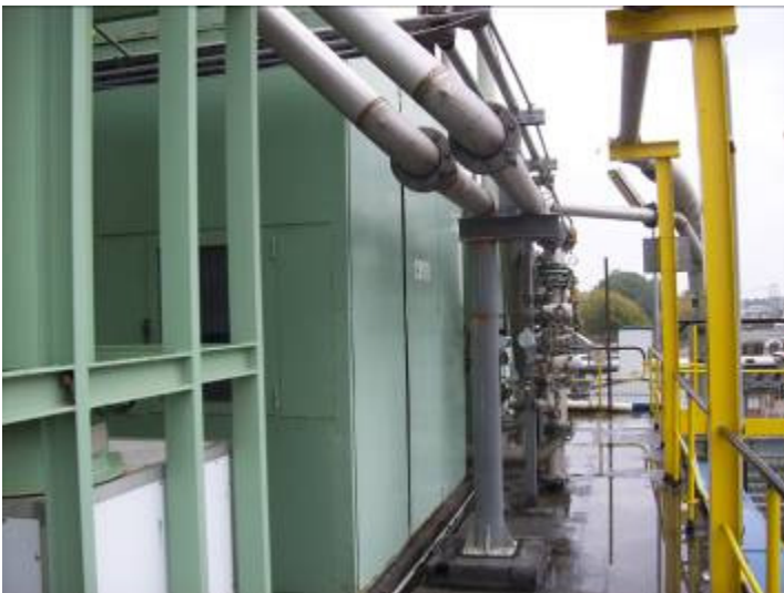
Postazione 15 – Impianto C817A (Compressore Riciclo Siletti dell'Estrusore) – Vista Posteriore Il piano di calpestio dell'impianto si trova a 7,3m dal suolo.
