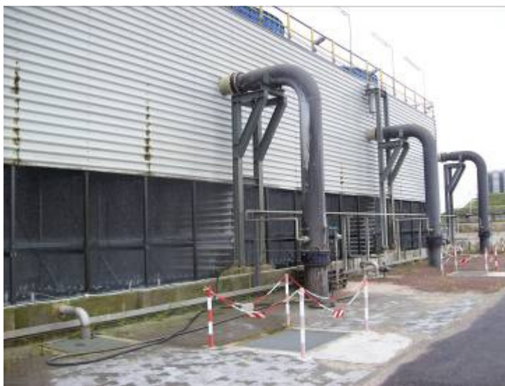
Postazione 27 – Torre Evaporativa, Area Ricircolo acqua Vista frontale
