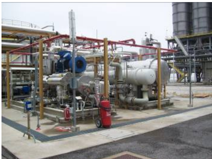
Postazione 51 – Impianto Y506A (Ciclo Frigorifero), Vista Frontale
