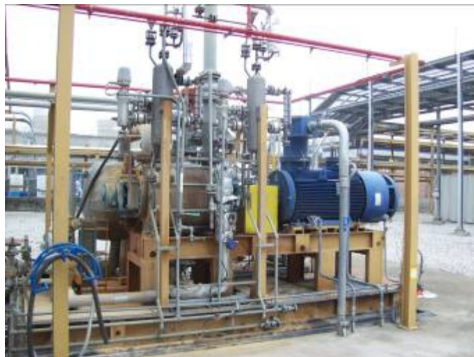
Postazione 31 – Impianto P801 (Compressore Recupero Gas del collettore di torcia), Vista Laterale
