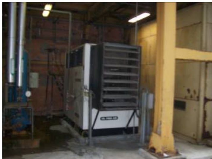
Postazione 34 – Impianto P519B (Compressore Aria Strumenti)
