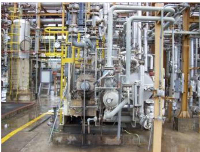
Postazione 4 – Impianto C405 (Compressore Off-gare) Vista Frontale
