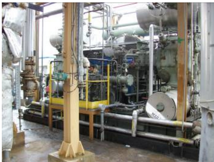
Postazione 8 – Impianto C304 (Compressore di Recupero Gas) Vista Frontale
