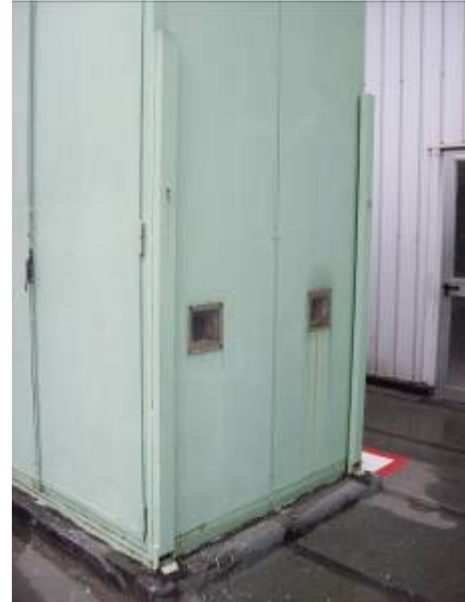
Postazione 15 – Impianto C817A (Compressore Riciclo Siletti dell'Estrusore) – Vista Frontale Il piano di calpestio dell'impianto si trova a 7,3m dal suolo.
