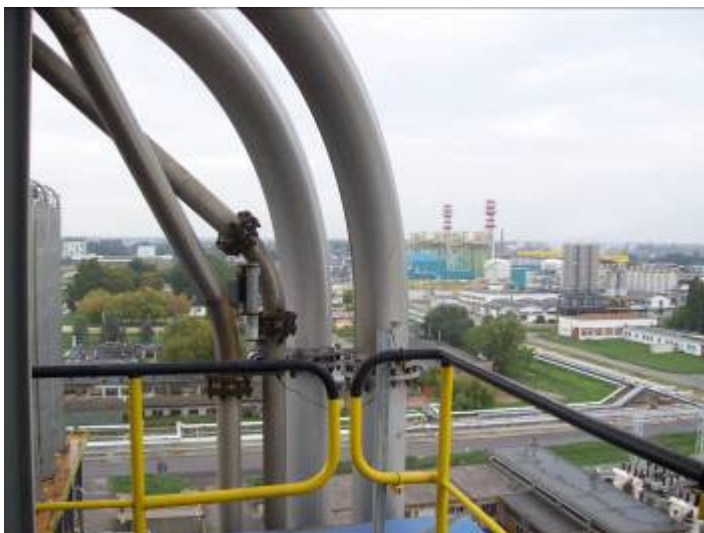
Postazione 18 – Linea di Trasporto Polimeri ai Sili dell'Estrusore Il piano di calpestio dell'impianto è situato a 31,2m dal suolo
