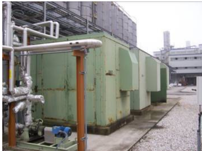
Postazione 32 – Impianti P610, P620, P621 (Compressori Trasporto Polimeri) Vista Frontale
