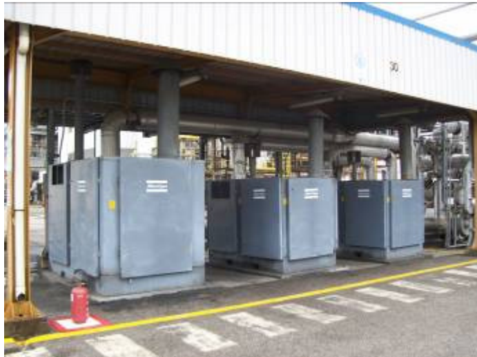
Postazione 11 – Impianti C801, C802A, C802B (Compressori per Trasporto Polimeri) Vista Frontale
