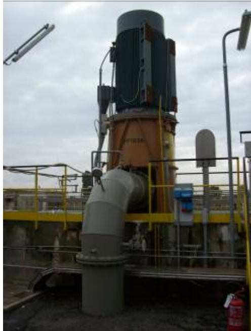
Postazione 30 – Pompa FP703A (Pompa per Torre Evaporativa) Veduta aerea
