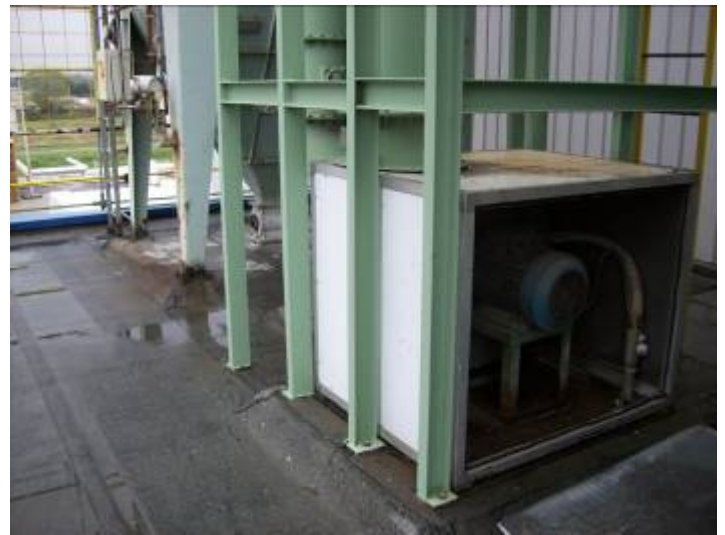
Postazione 16 – Impianto C820 (Compressione Aspirazione Polimeri) – Vista Frontale Il piano di calpestio dell'impianto si trova a 7,3m dal suolo.
