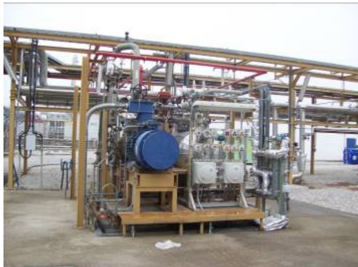
Postazione 31 – Impianto P801 (Compressore Recupero Gas del collettore di torcia), Vista Frontale
