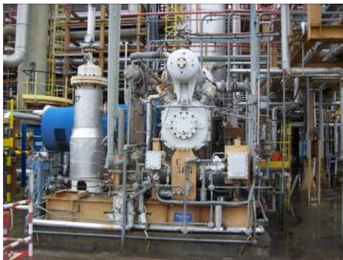
Postazione 2 – Impianto C303 (Compressore di Recupero Gas) Vista Laterale
