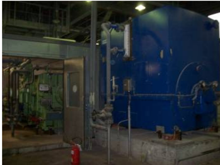
Postazione 36 – Impianto PT9001 – Motore Estrusore
