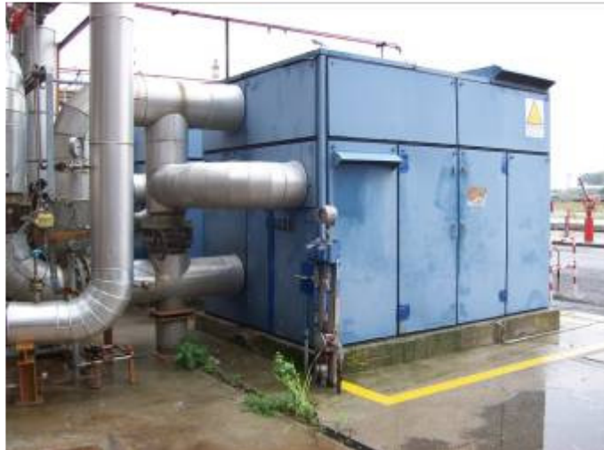
Postazione 3 – Impianto C402B (Impianto Fluidizzazione Dryer) Vista Posteriore
