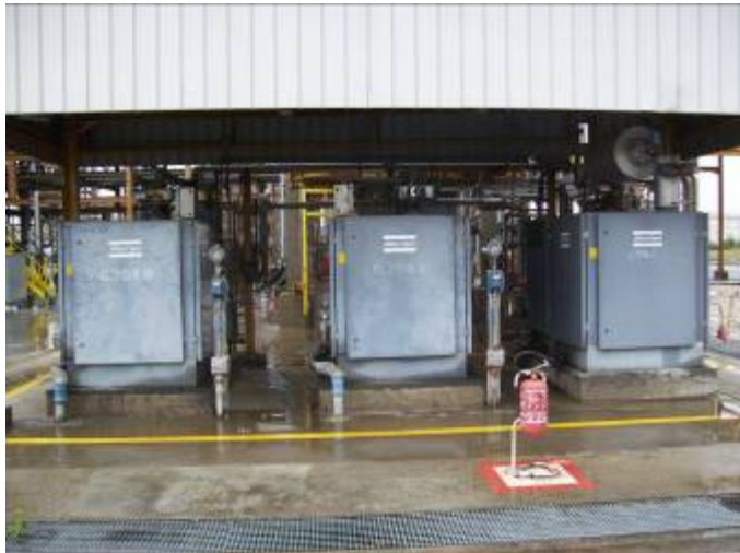
Postazione 5 – Impianti C704A, C704B, C704C Compressione Aria Strumenti
