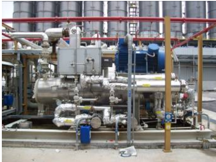
Postazione 51 – Impianto Y506A (Ciclo Frigorifero), Vista Laterale
