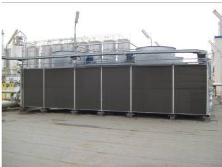
Postazione 41 – Impianti E303 (Scambiatori di Calore Raffreddamento Acqua fase gas), In prossimità di E303A e B
