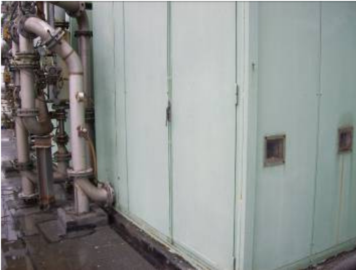
Postazione 15 – Impianto C817A (Compressore Riciclo Siletti dell'Estrusore) – Vista Frontale Il piano di calpestio dell'impianto si trova a 7,3m dal suolo.
