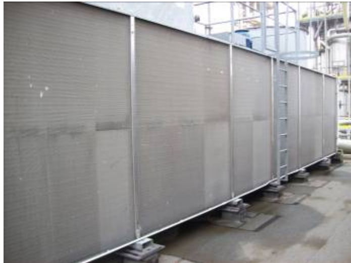
Postazione 40 – Impianti E303 (Scambiatori di Calore Raffreddamento Acqua fase gas), In prossimità di E303C e D
