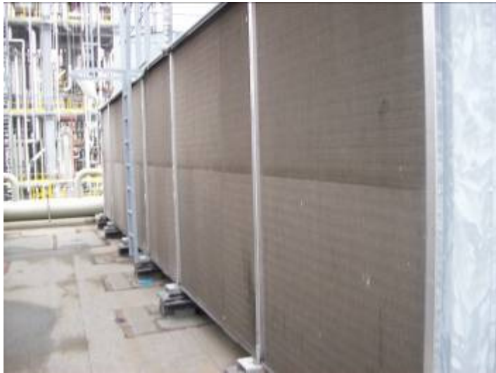
Postazione 39 – Impianti E303 (Scambiatori di Calore Raffreddamento Acqua fase gas), In prossimità di E303E e F
