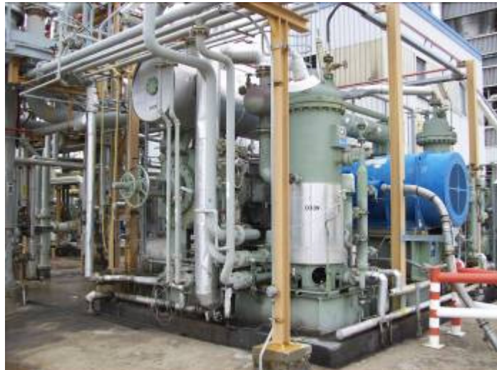
Postazione 8 – Impianto C304 (Compressore per Recupero Gas) Vista Laterale
