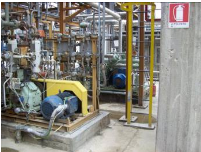
Postazione 48 – Impianti P401A e P401B (Pompe di Ricircolo Etilene verso Reattore), Vista Laterale
