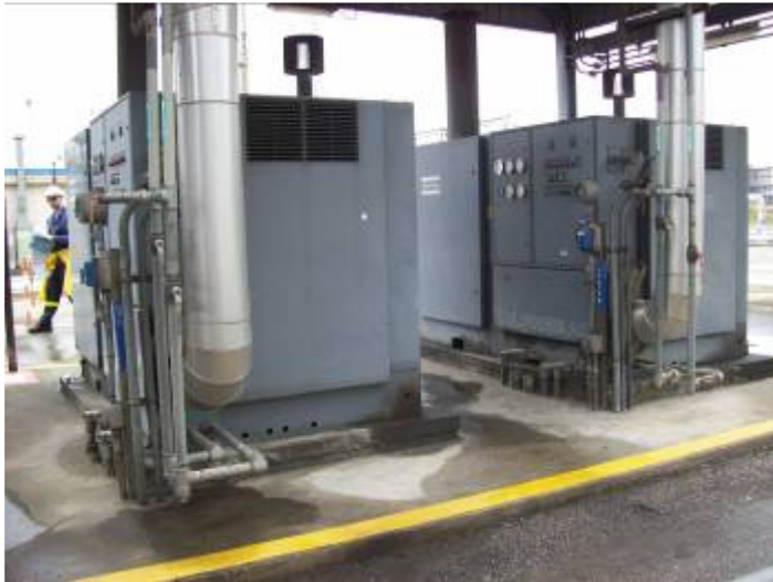
Postazione 13 – Impianti C815A e C815B (Compressori per Trasporto Polimeri) Vista Posteriore
