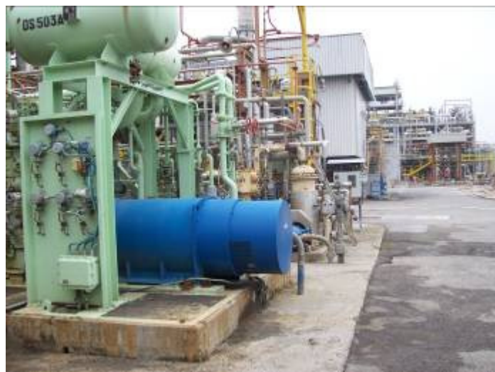
Postazione 49 – Impianto P501A (Compressore Recupero Gas) Vista Laterale
