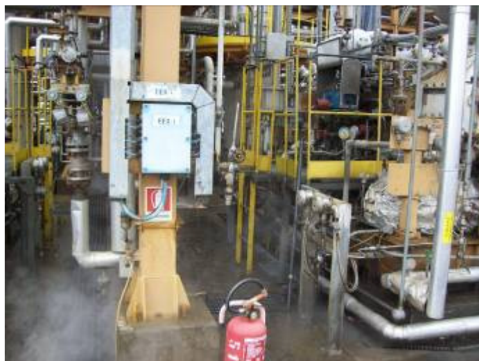
Postazione 1 – Impianto C301B (Compressore di Recupero Gas) Vista Laterale
