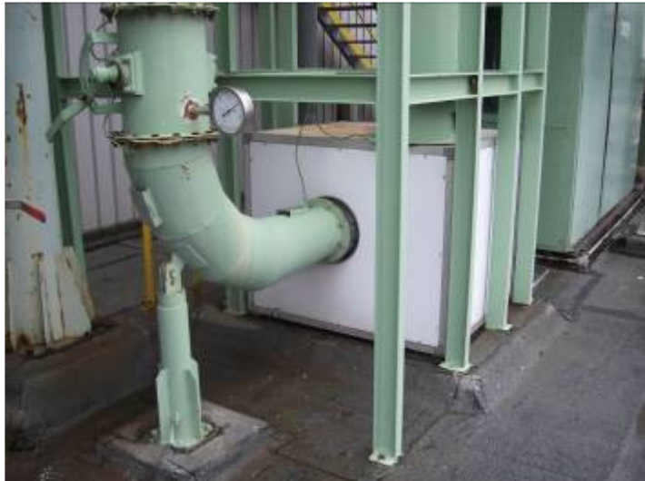
Postazione 16 – Impianto C820 (Compressione Aspirazione polimeri) – Vista Posteriore Il piano di calpestio dell'impianto si trova a 7,3m dal suolo.
