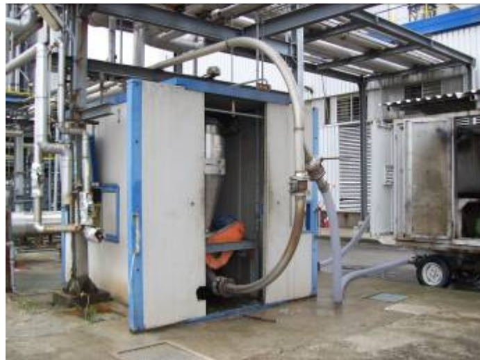
Postazione 14 – Impianto PK844 (Recupero Scarti) Vista Frontale
