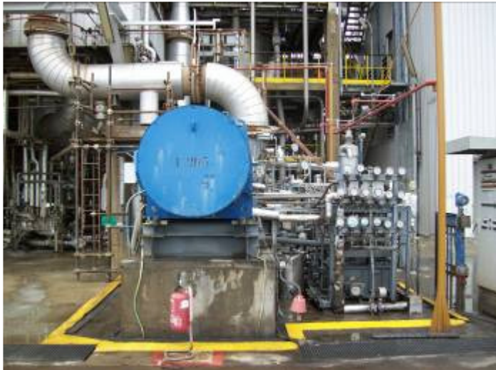
Postazione 7 – Impianto C203 di Fluidizzazione Vista Frontale
