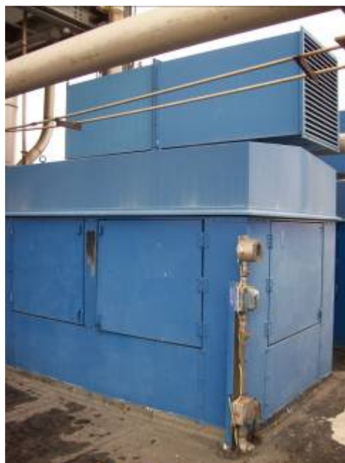
Postazione 25 – Impianto C501A (Compressori di Trasporto Dryer) Vista Laterale Il piano di calpestio è situato a 27,53m dal suolo.
