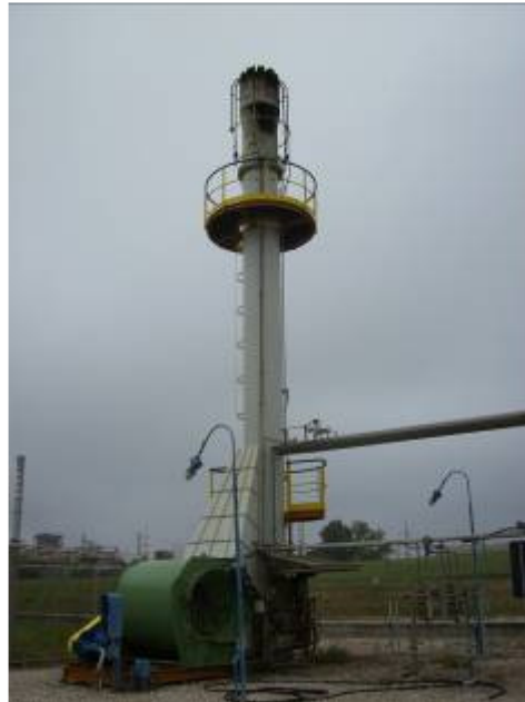
Postazione 53 – Ventilatore Torcia
