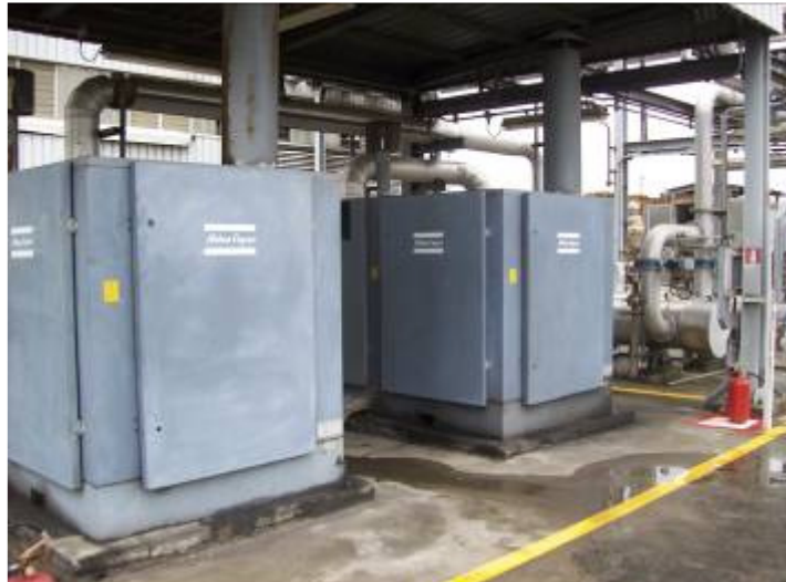
Postazione 13 – Impianti C815A e C815B (Compressori per Trasporto Polimeri) Vista Frontale
