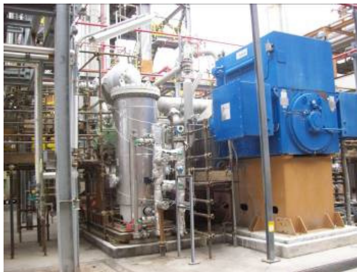
Postazione 42 – Impianto P301 (Compressore Recupero Gas) Lato Motore
