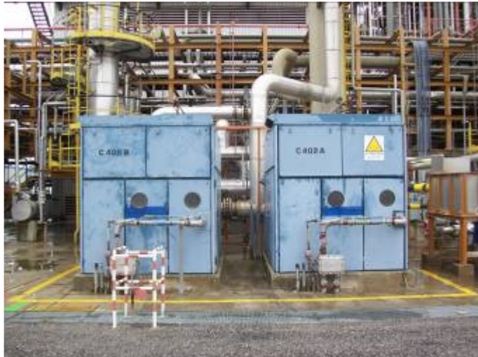
Postazione 3 – Impianto C402B (Impianto Fluidizzazione Dryer) Vista Frontale
