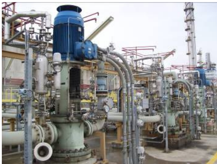
Postazione 26 – Pompe PO01 (Pompe del parco di stoccaggio monomeri) – Vista lato posteriore Il piano di calpestio è situato a 1m al di sotto del livello del terreno circostante.
