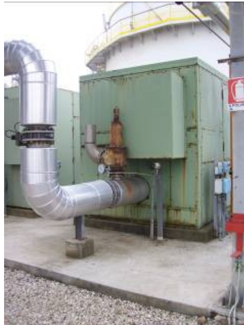
Postazione 32 – Impianti P610, P620, P621 (Compressori Trasporto Polimeri) Particolare: Tubi di trasporto
