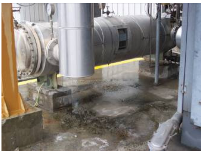
Postazione 6 – Impianti C506A, C506B Compressori per Trasporto Polimeri, Particolare: Scarico
