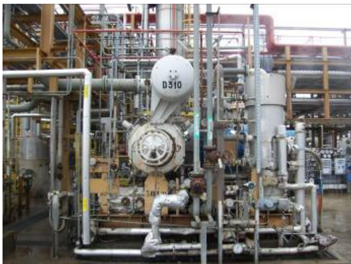
Postazione 1 – Impianto C301B (Compressore di Recupero Gas) Vista Frontale
