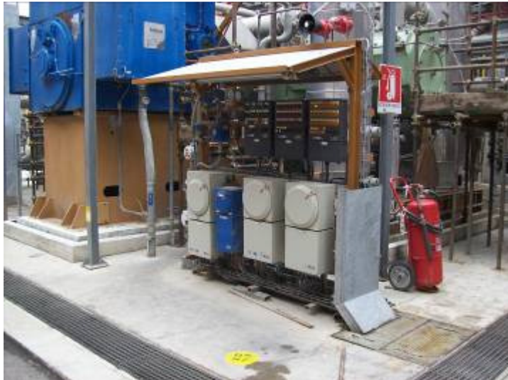
Postazione 43 – Impianto P301 (Compressore Recupero Gas) Lato Comandi
