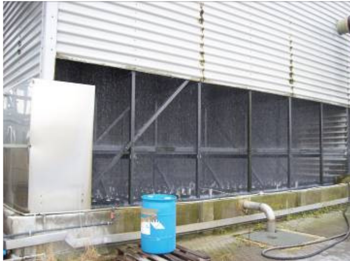
Postazione 27 – Torre Evaporativa, Area Ricircolo acqua Particolare: Area di base
