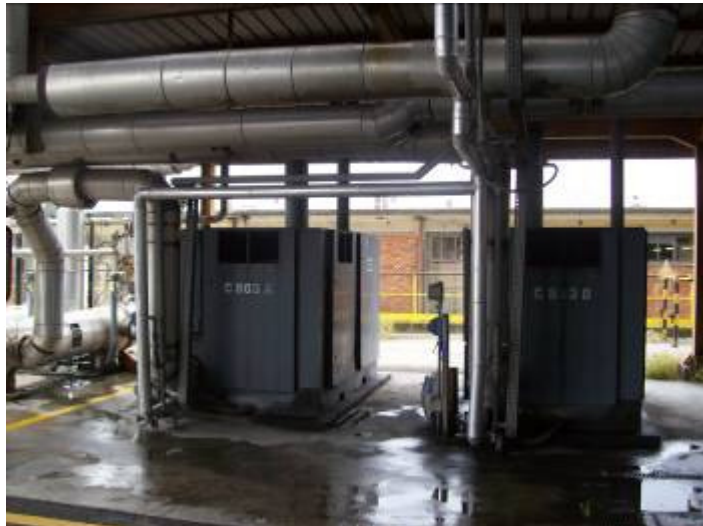
Postazione 19 – Impianti C803A e C803B (Compressori per Trasporto Polimeri) Vista Posteriore
