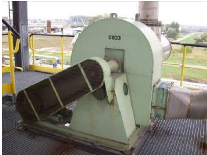
Postazione 23 – Impianto C833 (Compressore Captazione Polveri per Sileria 200m 3 ) Il piano di calpestio è situato a 8m di altezza dal suolo
