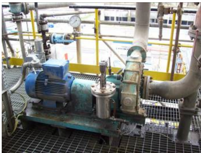
Postazione 9 – Impianto C204 (Compressore di Fluidizzazione per l'impianto T201) Il piano di calpestio è situato a 21,53m dal suolo
