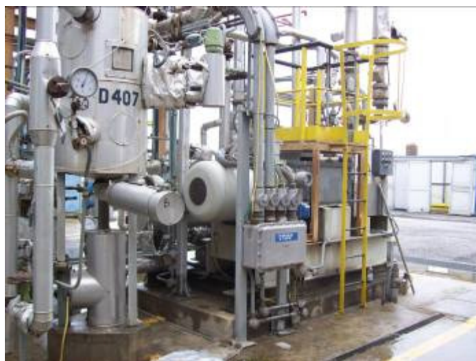
Postazione 4 – Impianto C405 (Compressore Off-gas) Vista Posteriore
