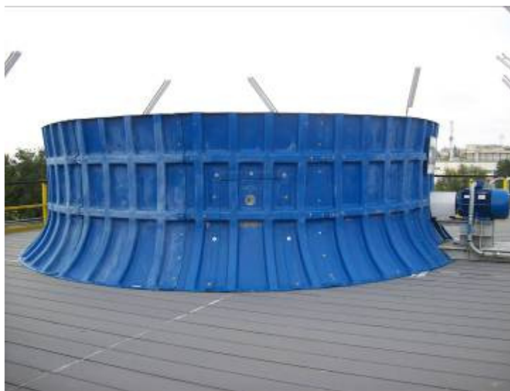
Postazione 28 – Torre Evaporativa, Area motore ventola
