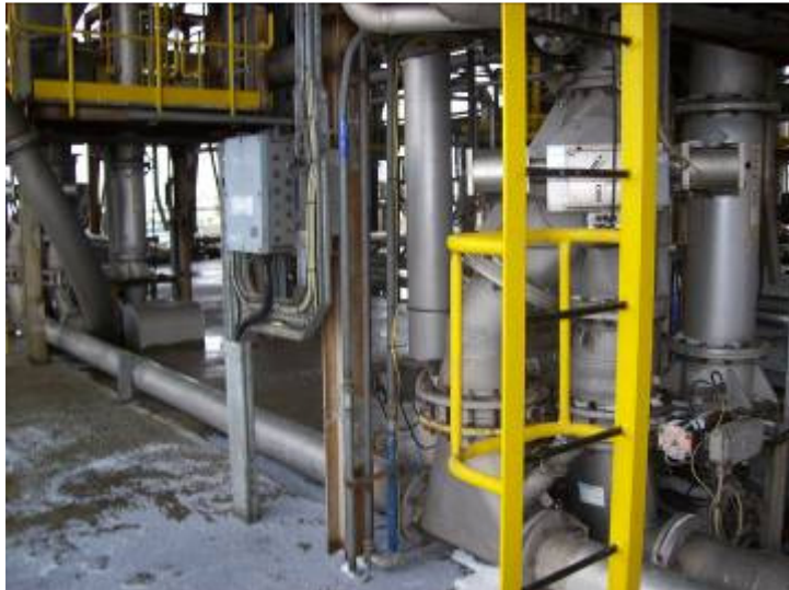
Postazione 20 – Sileria, 1° Piano, Lato Sud Linee per il ricircolo dell'aria
