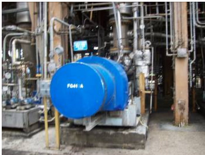
Postazione 46 – Impianto FG410A (Pompe di Ricircolo Propilene Liquido nei reattori)
