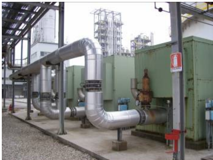
Postazione 32 – Impianti P610, P620, P621 (Compressori Trasporto Polimeri) Vista Posteriore
