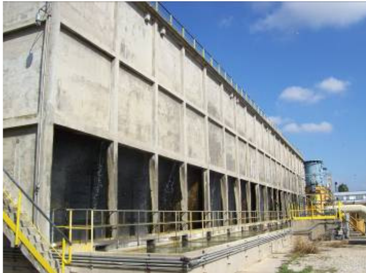
Area MPX LPG: Torri di Refrigerazione, Lato Sud
