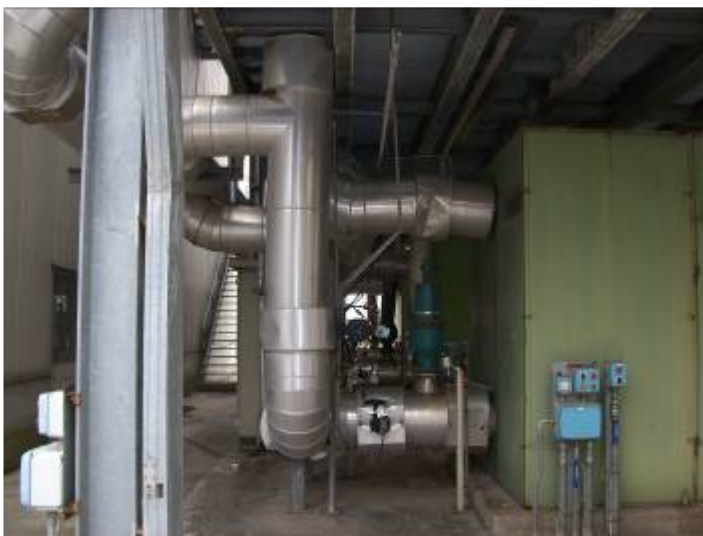
Postazione 38 – Impianto P956A (Trasporto Polimeri da Impianto a Estrusore), Lato Estrusore
