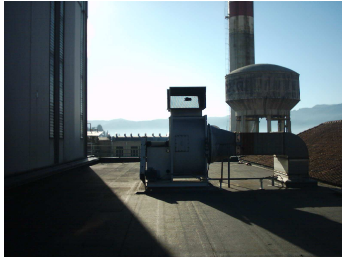
Area Ventilatori (S10) – particolare della Sorgente e
