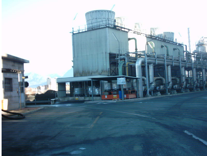
Torri di raffreddamento (S1) lato sud
