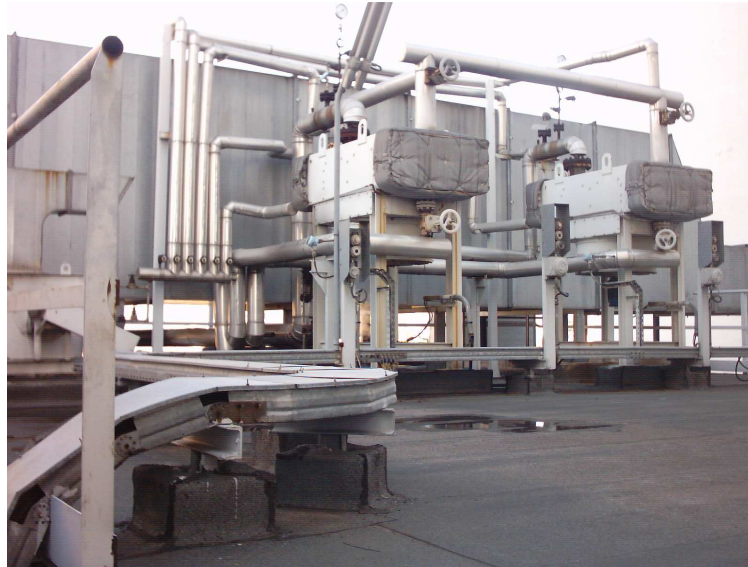
Area Ventilatori (S10) – particolare della Sorgente d
