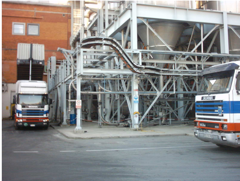
Area Stoccaggio Chips: particolari delle sorgenti S7- silos e S8 – Product cooling area
