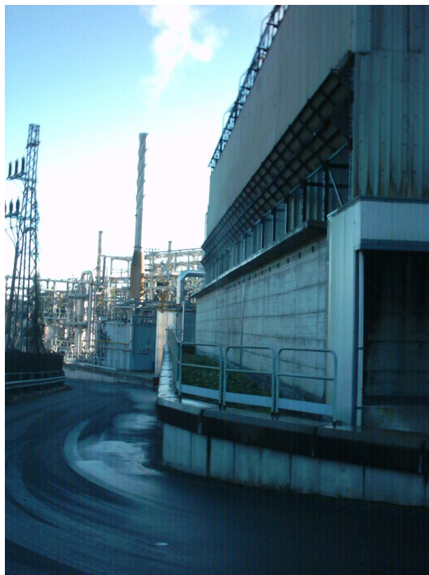
Torri di raffreddamento (S1) lato nord
