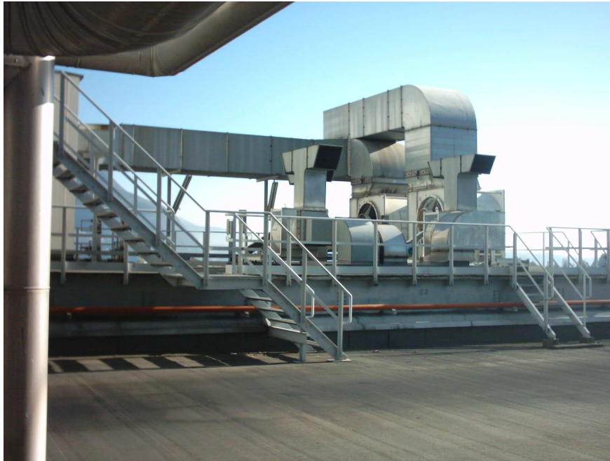
Area Ventilatori (S10) – particolare della Sorgente b
