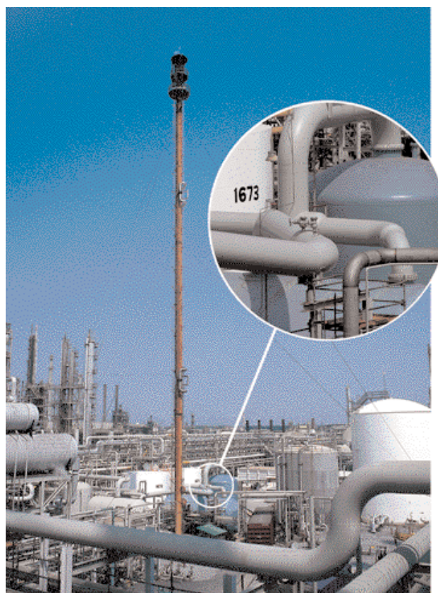
Installazione sul campo del DigitalFlow GF868 in un tipico sistema di accensione. L'insero mostra i trasduttori installati sul collettore di accensione che porta al condotto di accensione.
