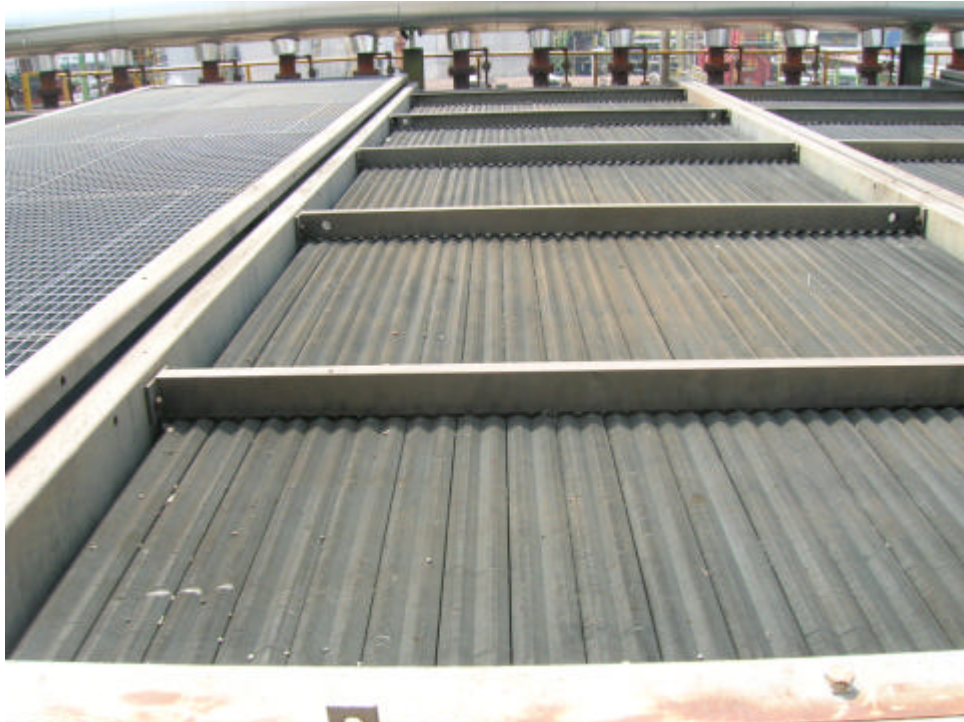
Fig. 3.3: Air Cooler - Veduta della parte superiore
