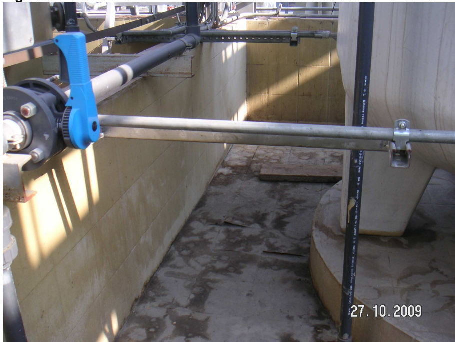
Figura 3: Particolare del rivestimento interno dei sottobacini di contenimento
