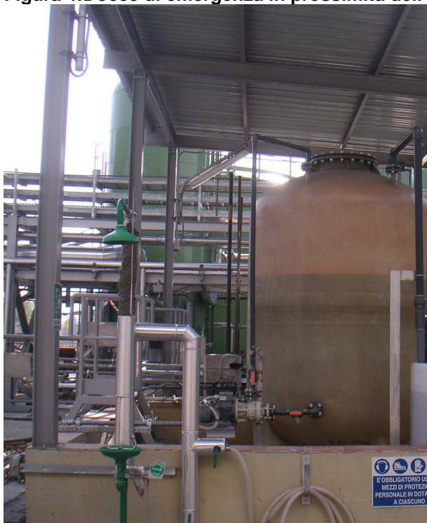
Figura 4: Docce di emergenza in prossimità dell'area AS4
