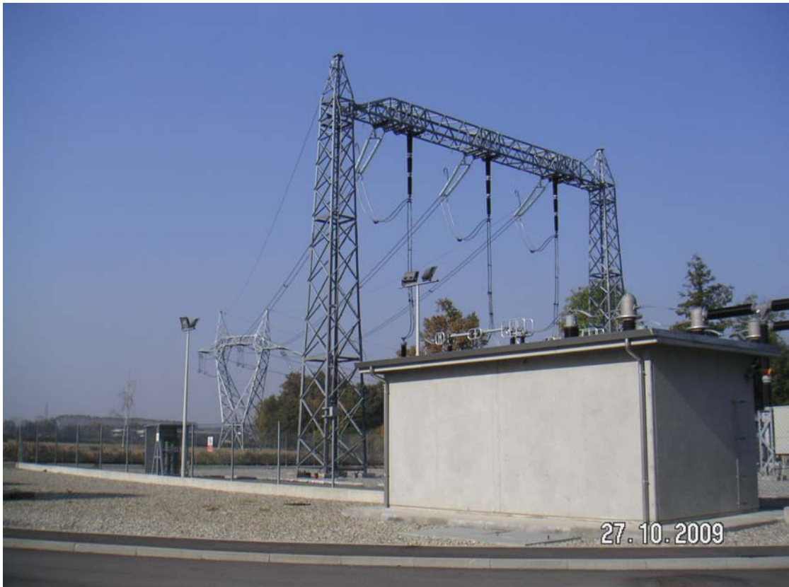
Figura 1 – Stazione elettrica di uscita dell'elettrodotto, interna alla Centrale
