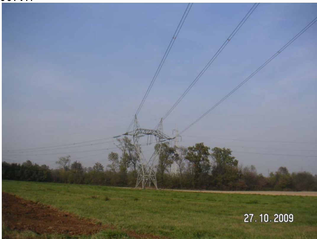
Figura 19 – Sostegno PV17, vista dalla strada a sud
