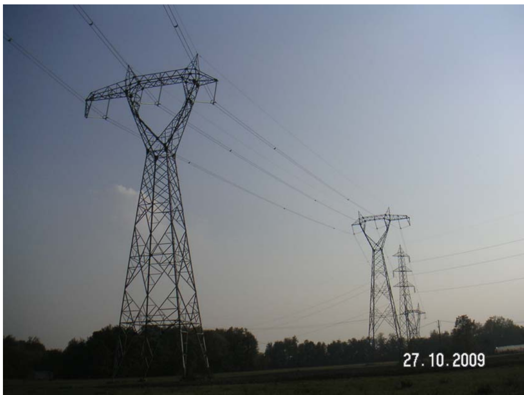
Figura 18 – Da sinistra a destra, sostegni PV16, PV15 e PV14. Intersezione con linea a 220 kV tra PV15 e PV14
