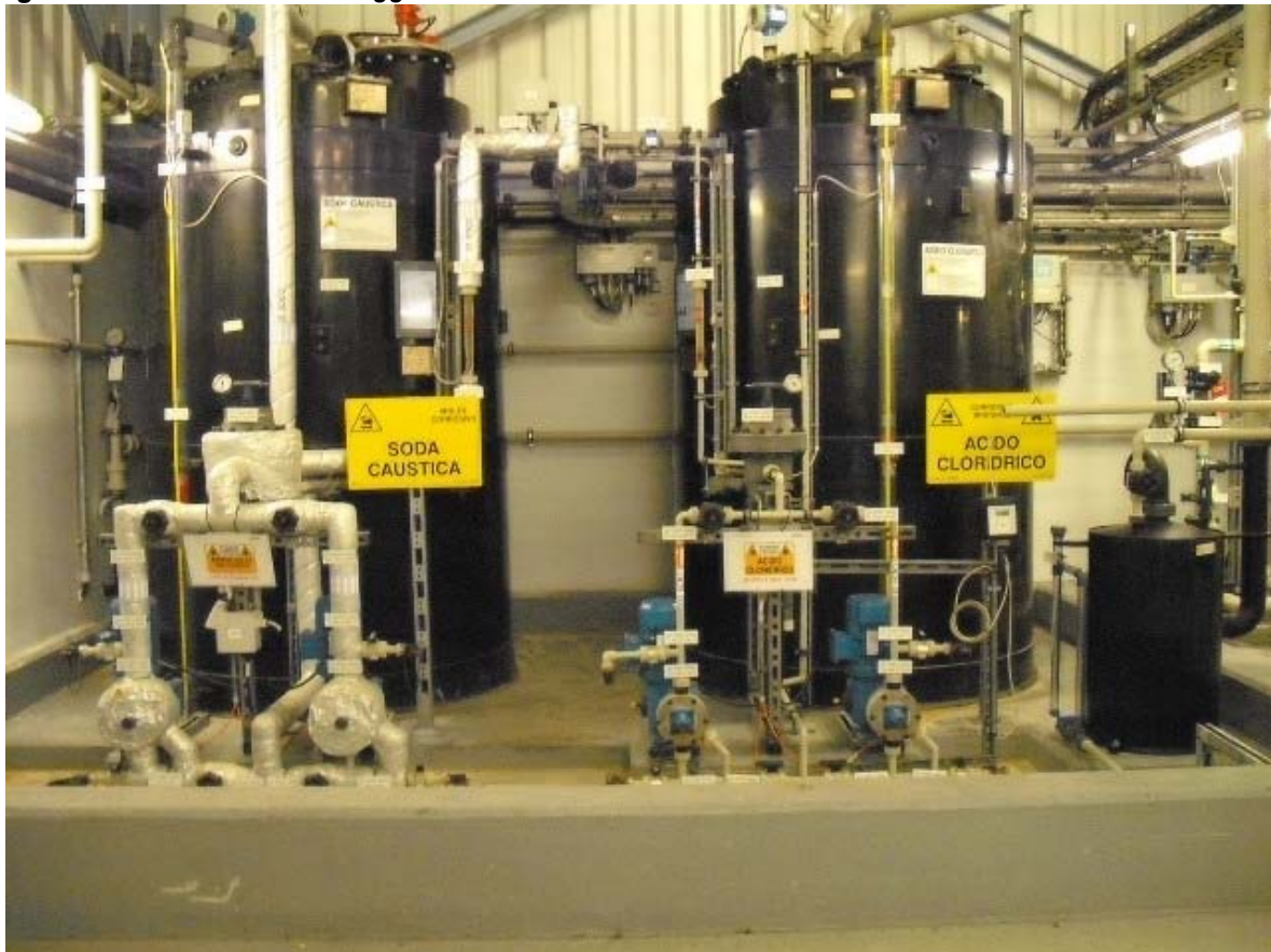
Figura 4.2: Serbatoi di stoccaggio dell'Idrossido di Sodio e dell'Acido Cloridrico
