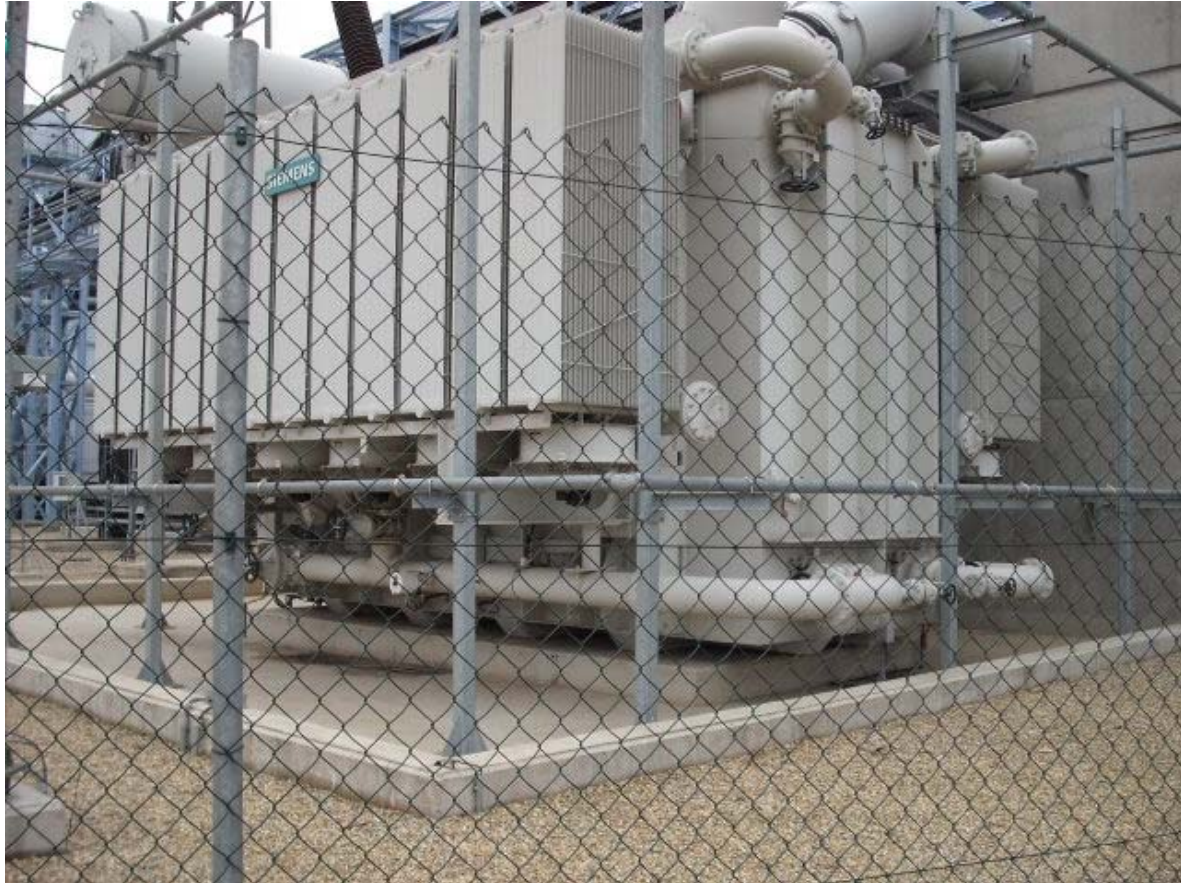
Figura 4.3: Bacini di contenimento dei trasformatori
