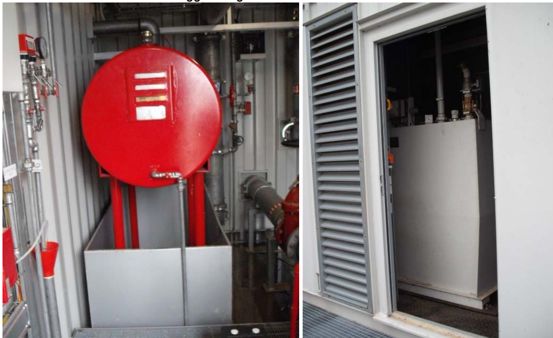
Figura 4.1b e c: Serbatoi di stoccaggio del gasolio
