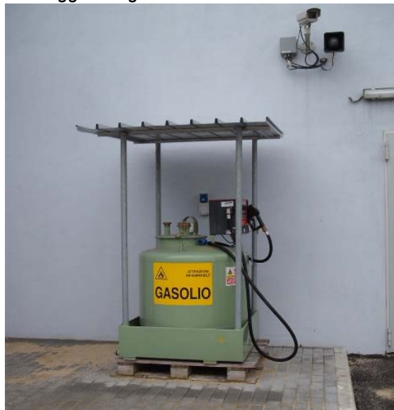
Figura 4.1a: Serbatoio di stoccaggio del gasolio
