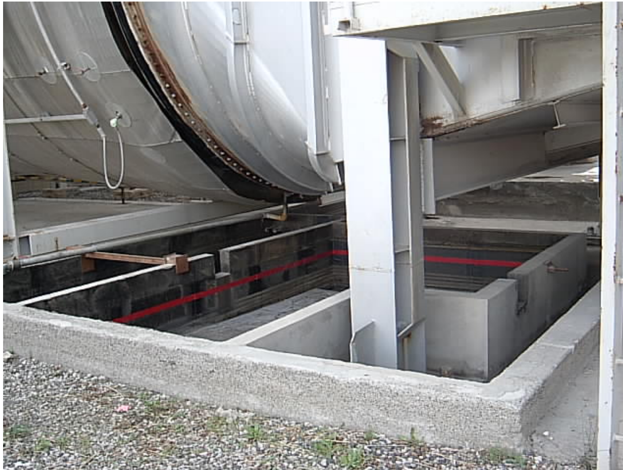
Vasca di raccolta acque di lavaggio TG - particolare fotografico
