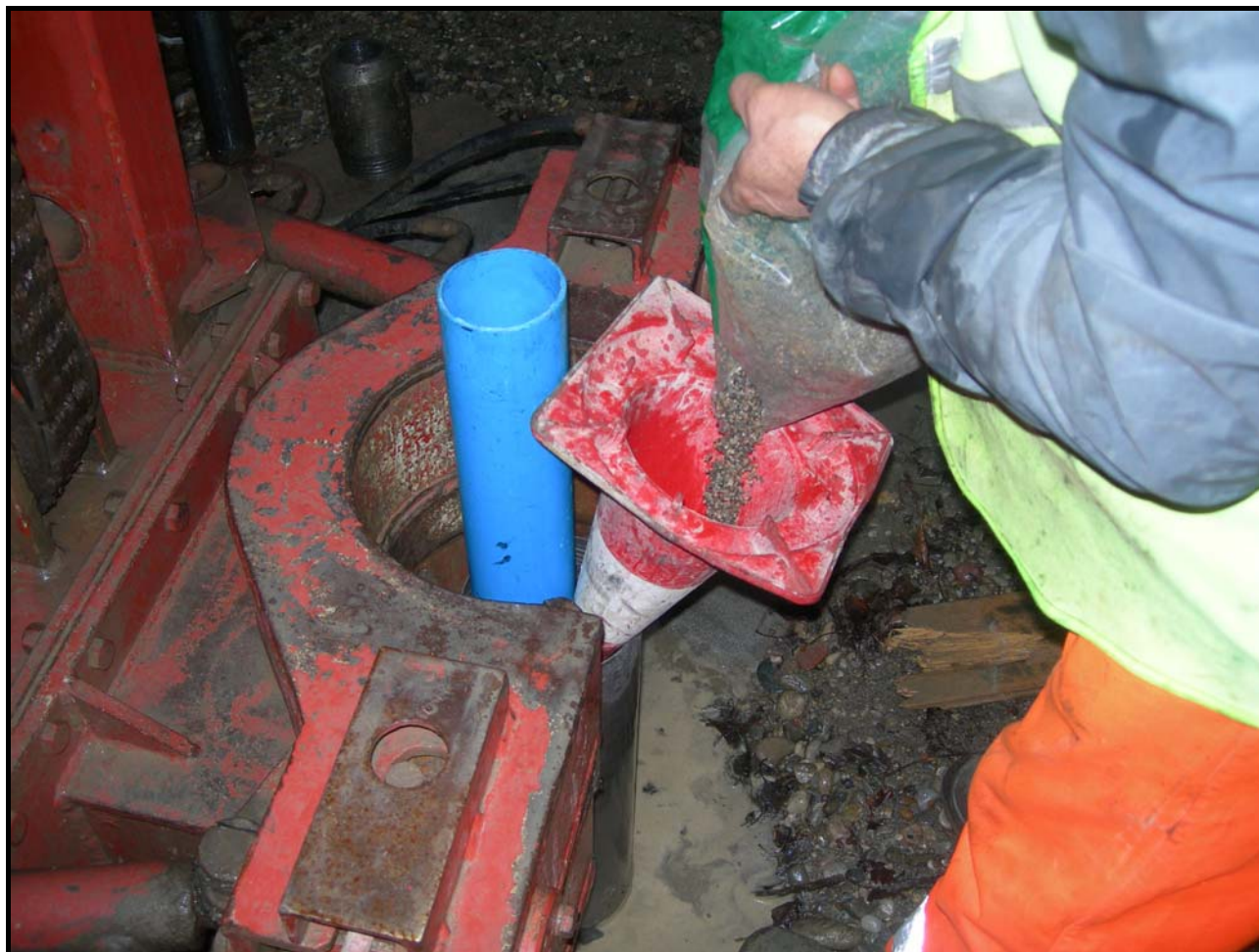
Foto 4: Particolare della fase di inserimento a gravità del ghiaietto (riempimento spazio anulare parete foro-tubo PVC)
