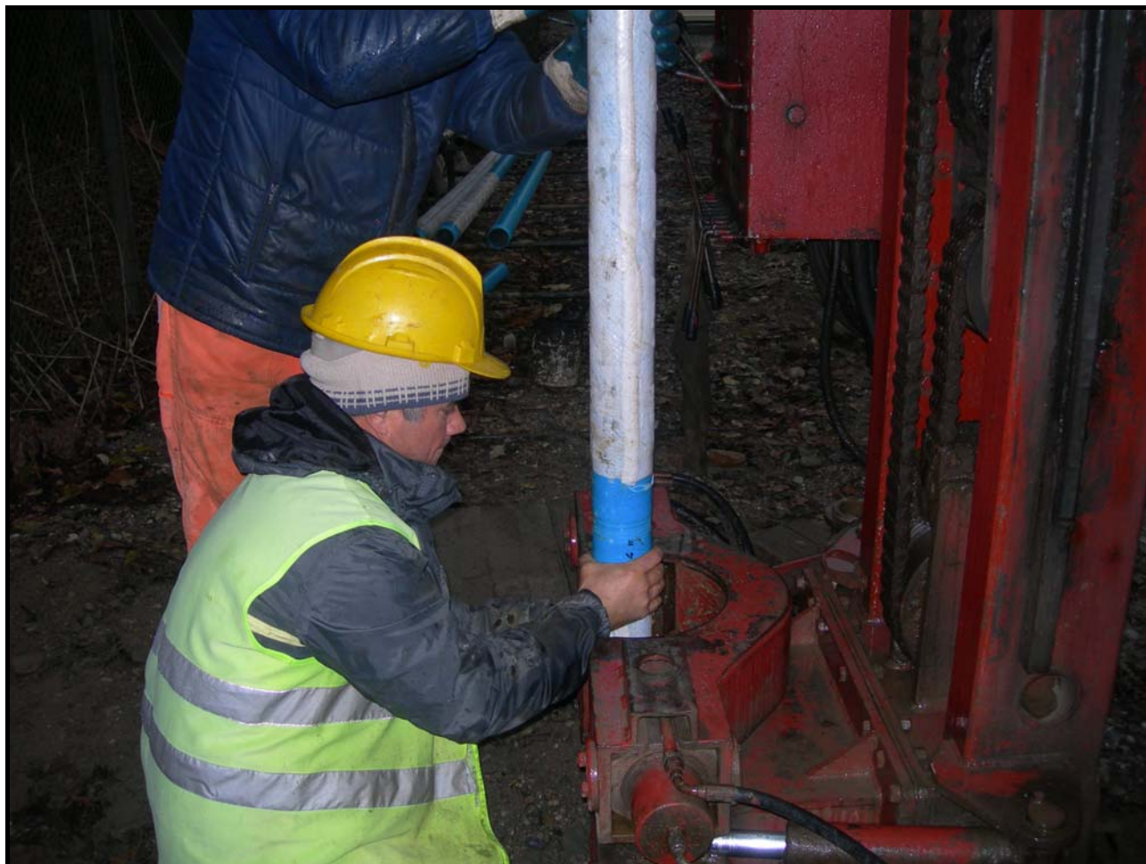
Foto 3: Particolare dell'infilaggio tubo in PVC rivestito in telo di tessuto non tessuto
