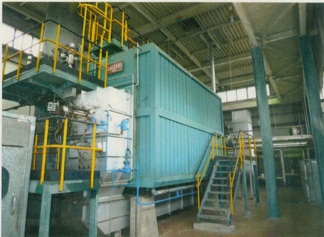
Vista dell'attuale caldaia
