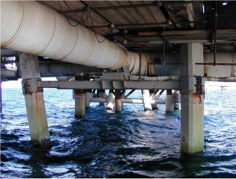
Fig. 8: tubazioni in corrispondenza alla piattaforma intersezione.
