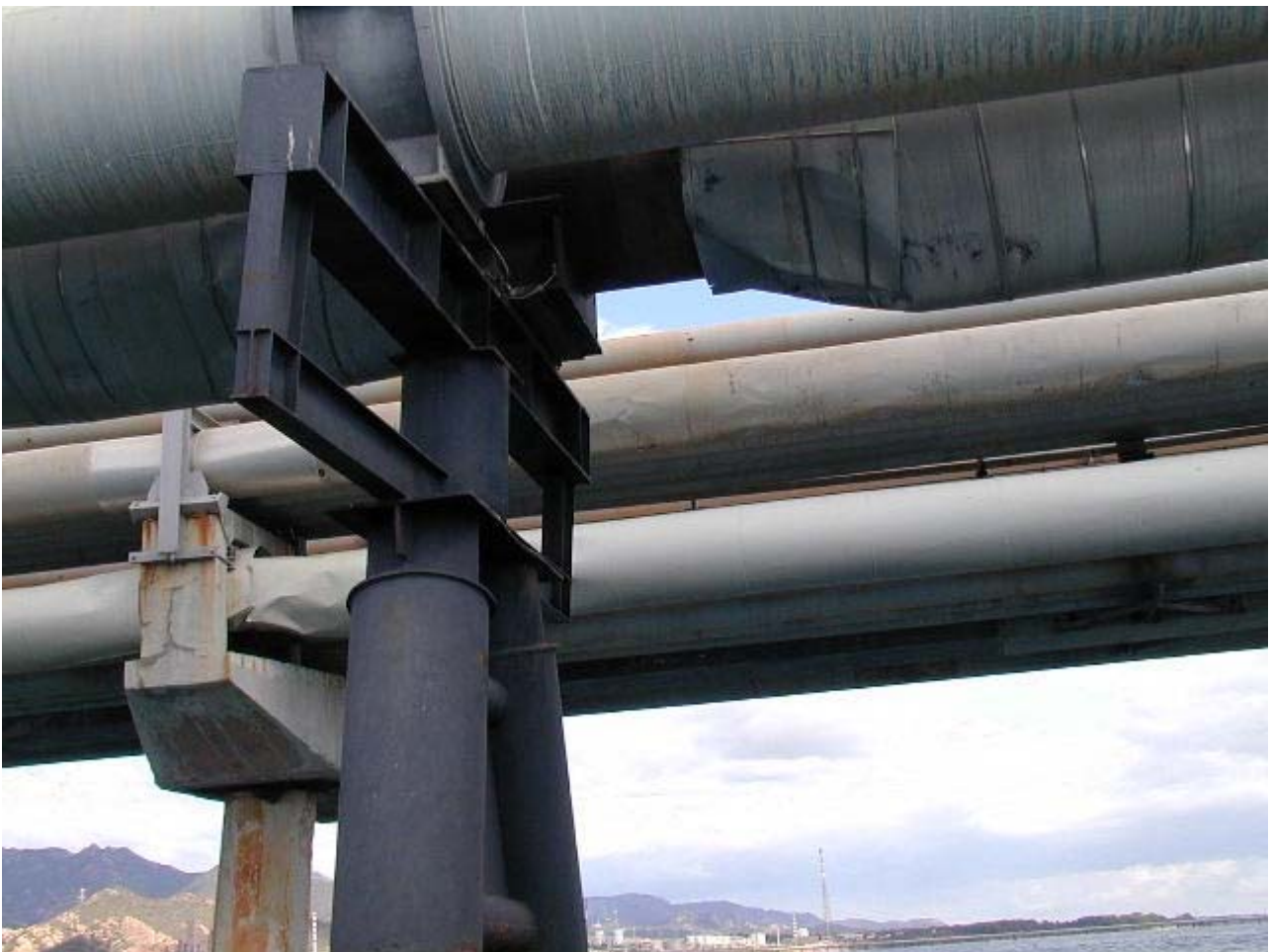
Figura 3: in primo piano, palificata del greggio sulla quale poggiano due tubi di grosso diametro. In secondo piano, il pontile principale.
