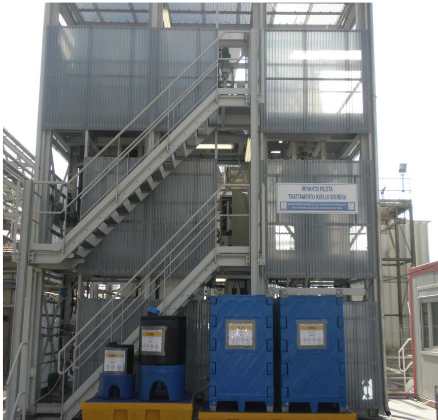
Foto 1. Vista frontale dello skid
