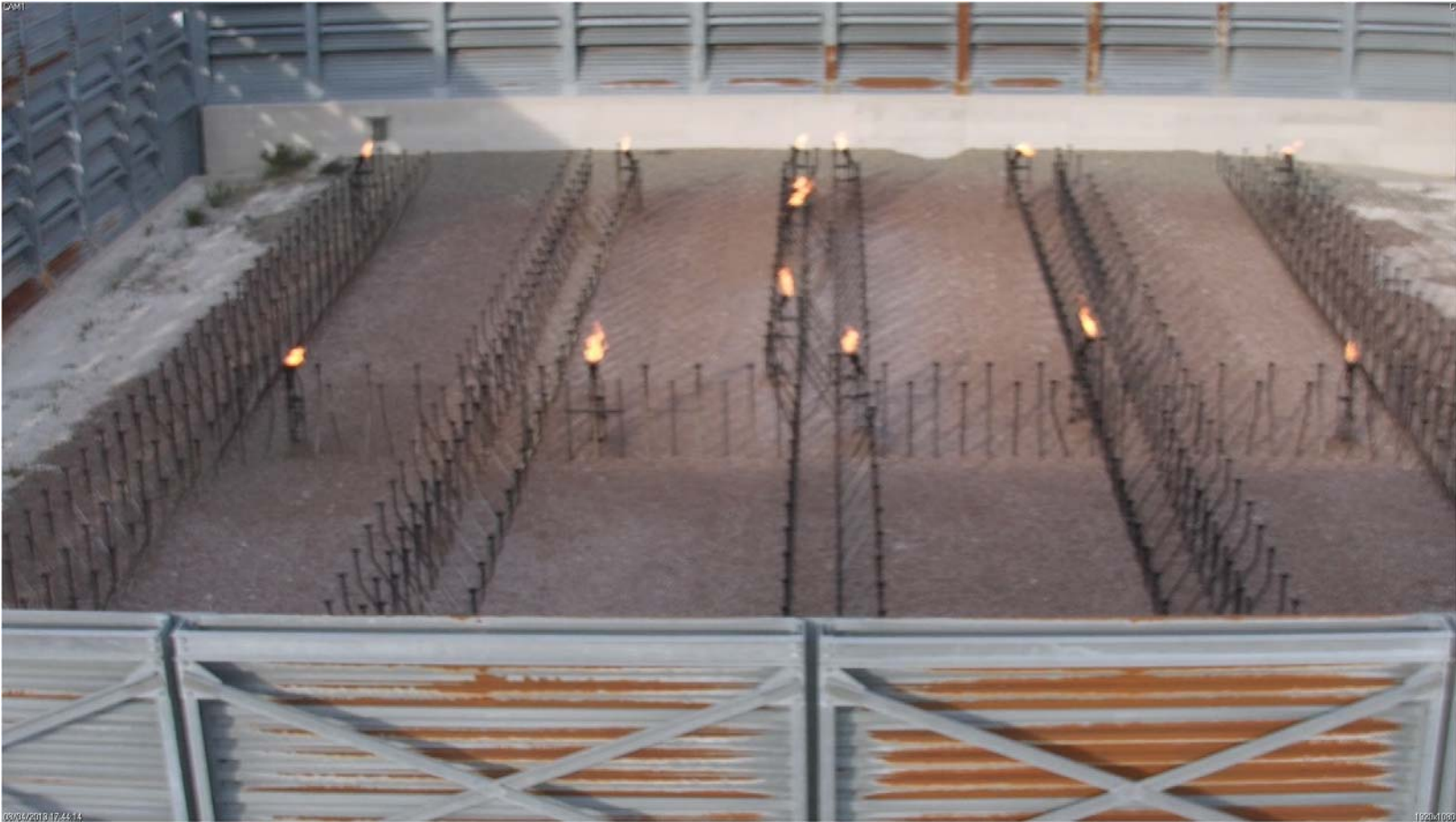
Foto panoramica della Ground Flare PK600
