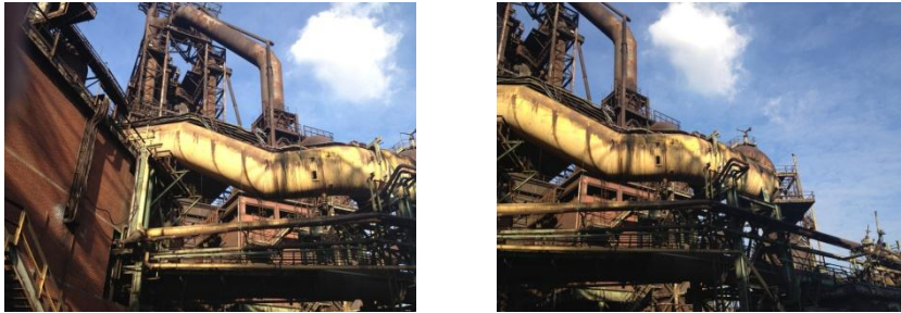
Foto 4: viste principali componenti e tubazioni
