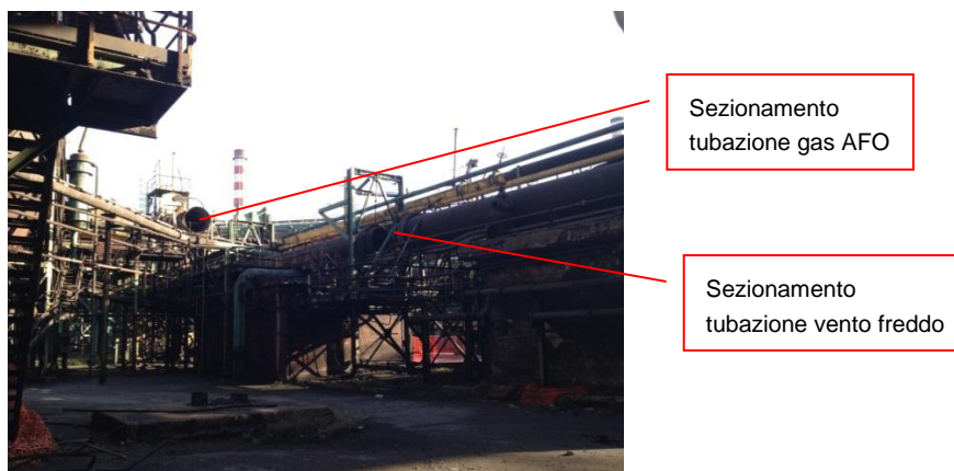
Foto 3 Sezionamento tubazione gas AFO e vento freddo
