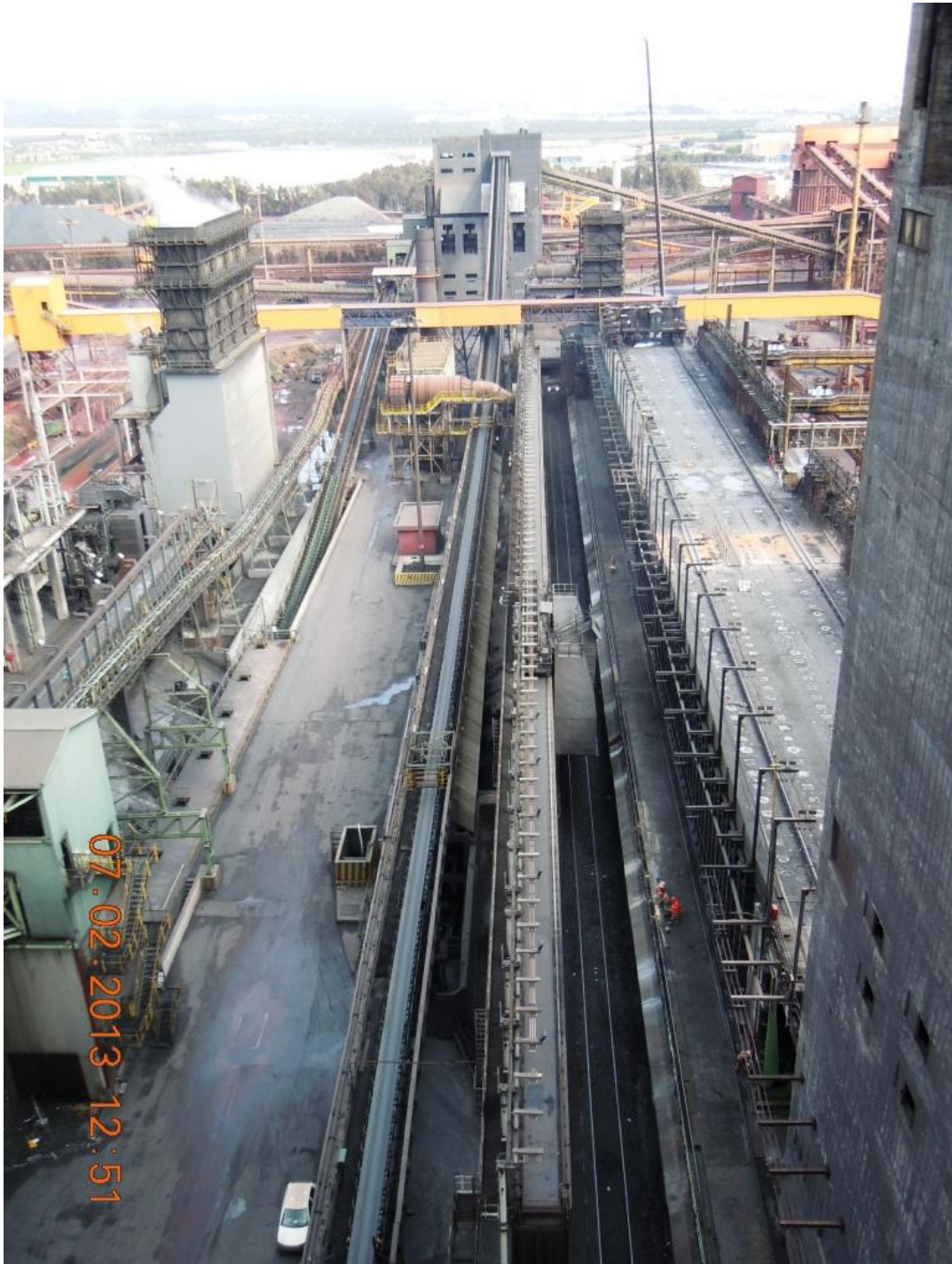
Foto Batterie IX-X Vista d'insieme lato coke
