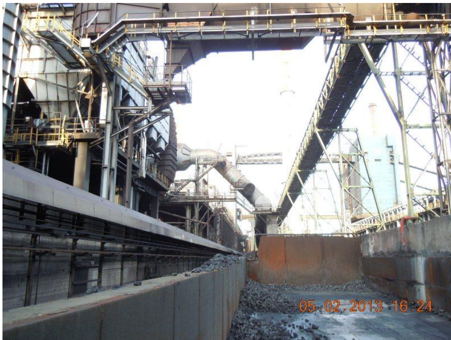
Foto Batteria XI Zona tra fine batteria e torre di spegnimento n°6. Dietro alla zona delimitata dalle lamiere inizia la rampa di scarico coke n°6
