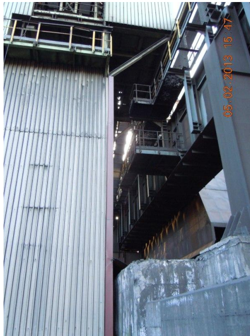
Foto Batteria XII Torre incrocio nastri NGT3 sul fianco della condotta di aspirazione fumi
