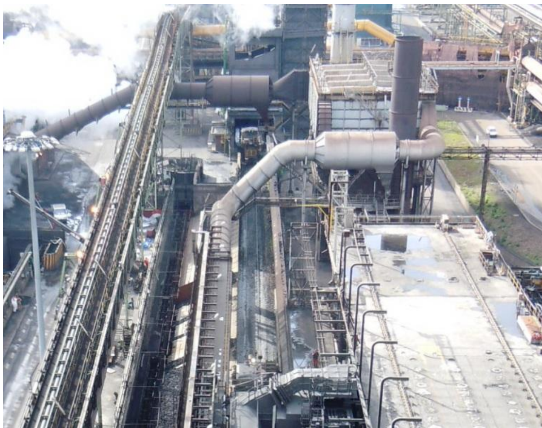
Batteria XI Tubazioni che attraversano la zona di scorrimento del carro coke tra batteria e torre di spegnimento n°6
