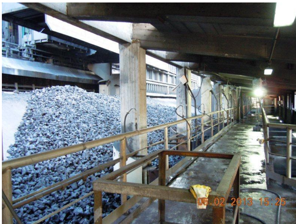
Foto Batterie IX-X Struttura in CA di sostegno al nastro 4/2 superiore davanti alle rampa n°5.
