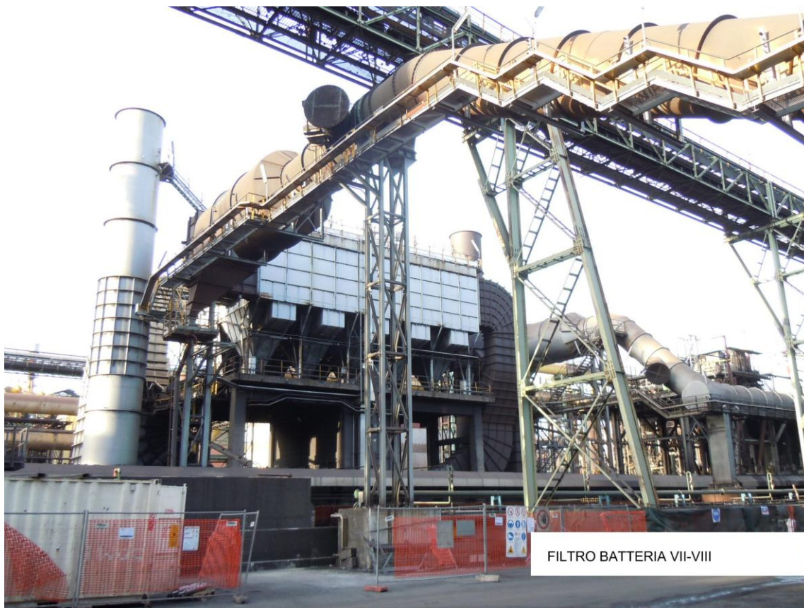
Foto Batterie VII-VIII . Gruppo aspiro-filtrante per il trattamento delle emissioni durante lo sfornamento.
