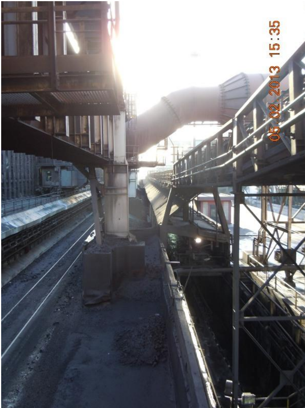
Foto Batterie IX-X Condotto di aspirazione e nastro del coke della Batteria 7-8 passante sopra alla rampa n°5.
