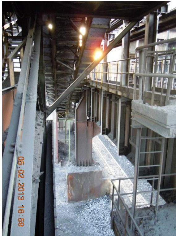
Foto Batteria XII Nastro trasportatore NG4/A sul fianco della condotta di aspirazione fumi
