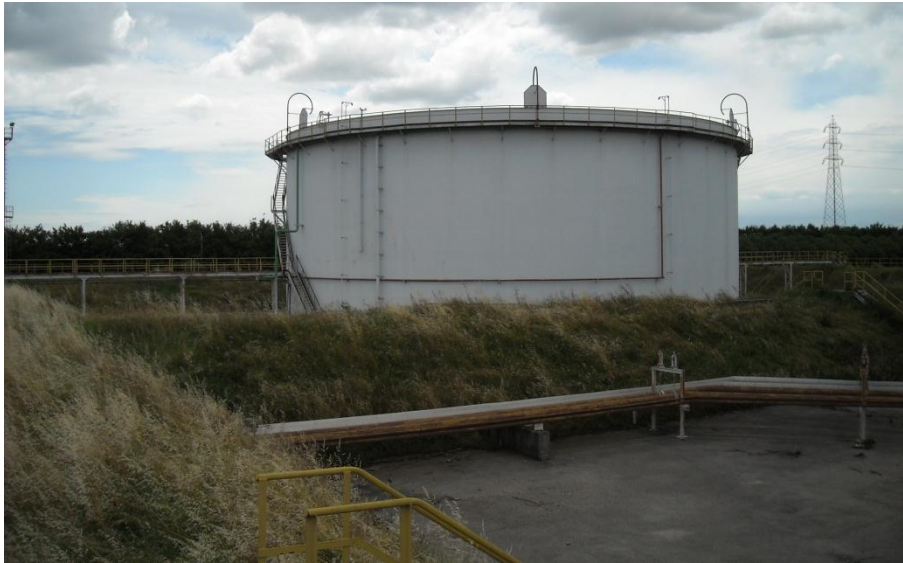
Figura 3 - Serbatoio di stoccaggio e relativo bacino di contenimento
