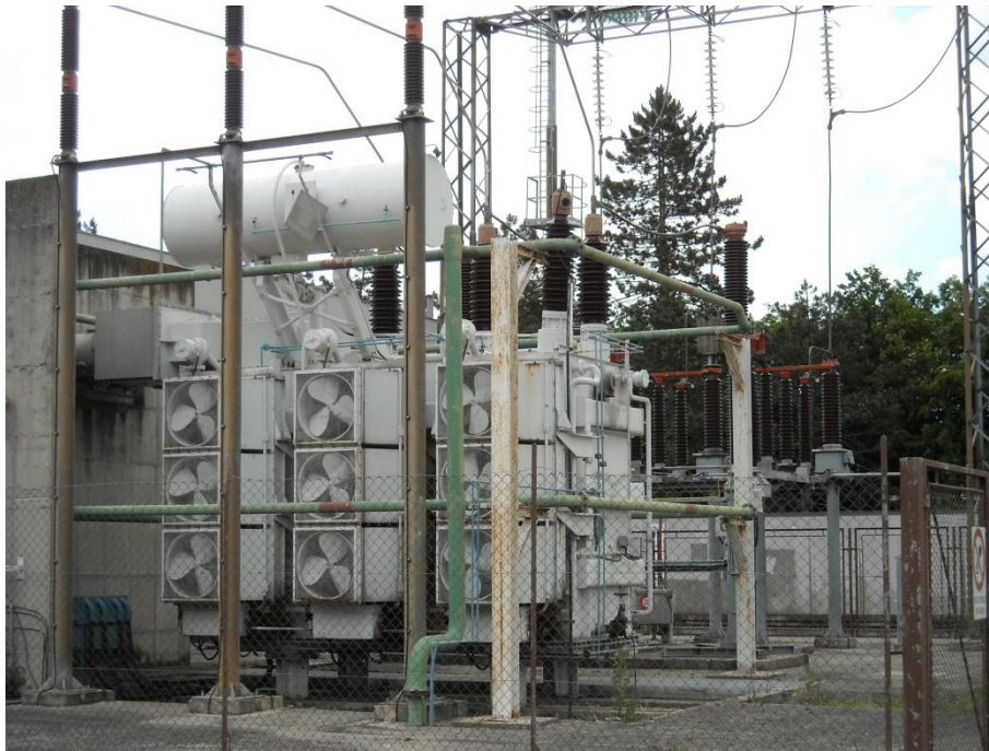
Figura 4 – Trasformatore di potenza e relativa vasca di contenimento
