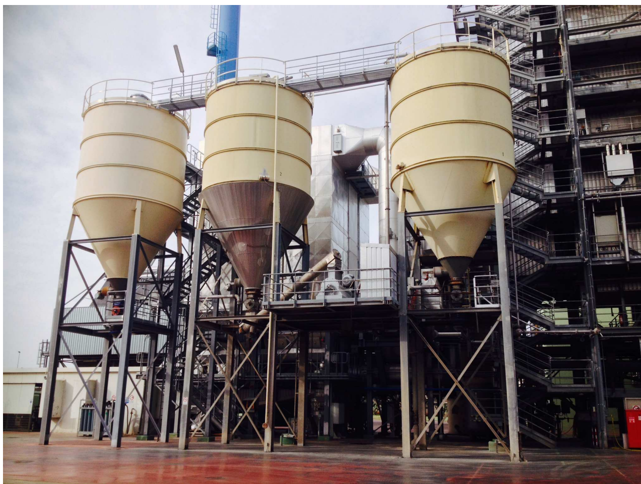
Figura 8 – Centrale BS1 – Silos di stoccaggio delle ceneri
