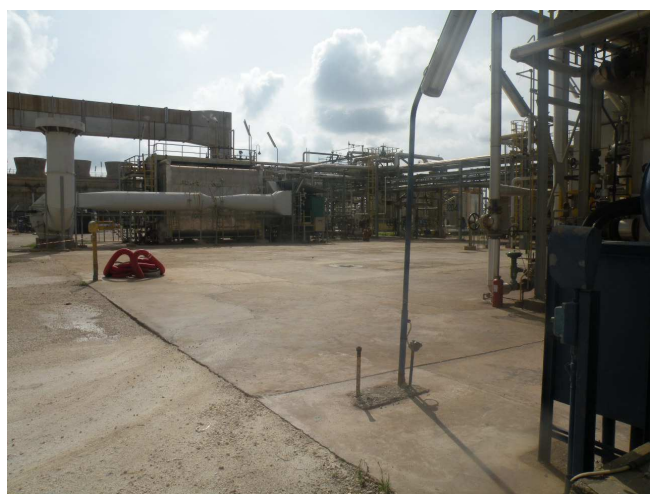
Pavimentazione in cls su cui poggia la caldaia
