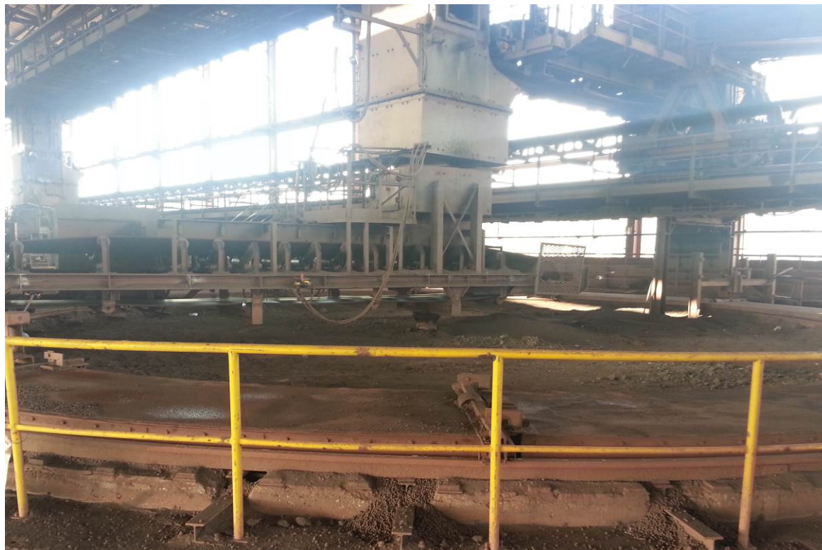
Figura 5: Panoramica nastro ripartitore e giostra (piano giostre).
