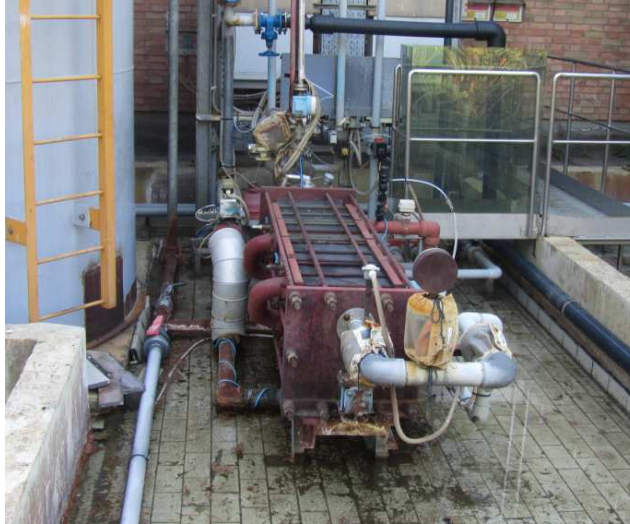
Scambiatore per il raffreddamento della miscela acqua demi-acido solforico
