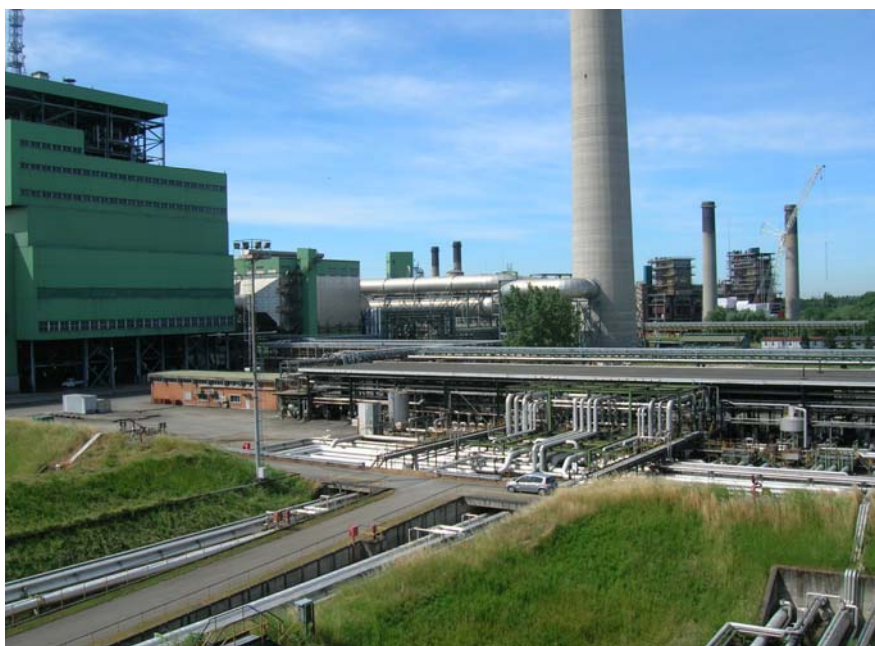
Foto 16: Area 2 Parco combustibile nord – Stazione pompaggio combustibile GR. 5-6 e GR.7-8
