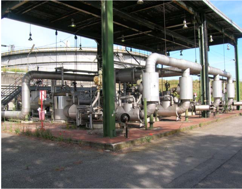
Foto 26: Area 3 Parco combustibile sud – Stazione di pompaggio combustibile
