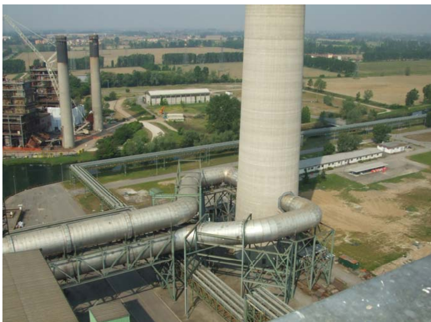
Foto 9: Area 1 GR 7-8 – Sistema di adduzione fumi alla ciminiera particolare 1
