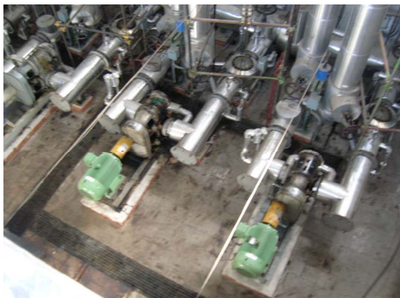
Foto 32: Area 4 Stazione di scarico o.c. – Particolare pompe
