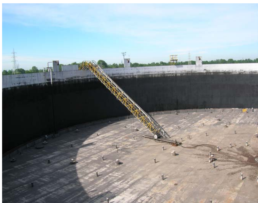
Foto 25: Area 3 Parco combustibile sud – Particolare serbatoio N°6 particolare tetto galleggiante
