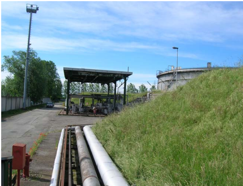
Foto 27: Area 3 Parco combustibile sud - Particolare piping dalla stazione di pompaggio ai serbatoi
