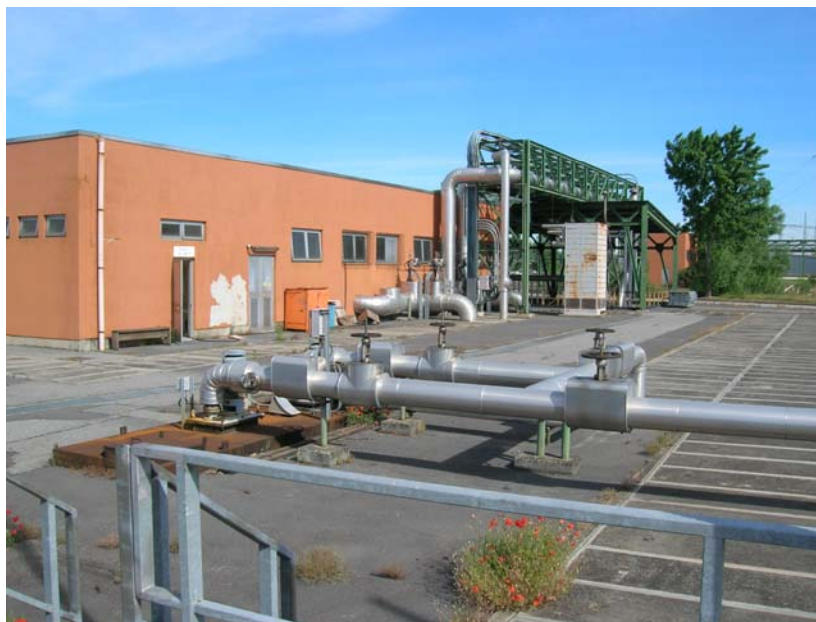
Foto 31: Area 4 Stazione di scarico o.c. – Edificio stazione pompaggio
