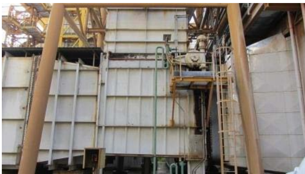
Figura n. 4 - Diverter box installato sui Turbogas di Rossano
