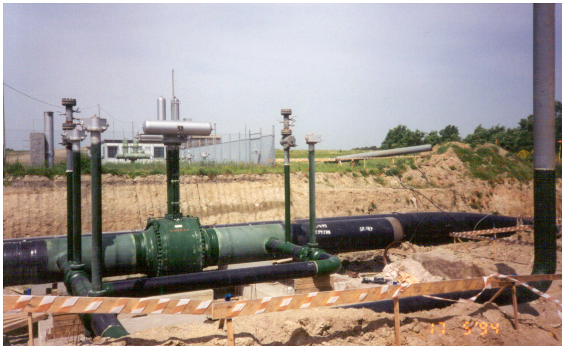
Foto 5.1/N Impianto di intercettazione di linea (PIL)
