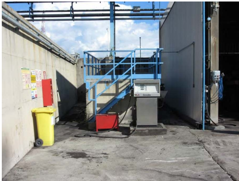
Figura 7: distributore di carburante e relativo serbatoio (sulla destra è visibile il sistema di controllo delle eventuali perdite)
