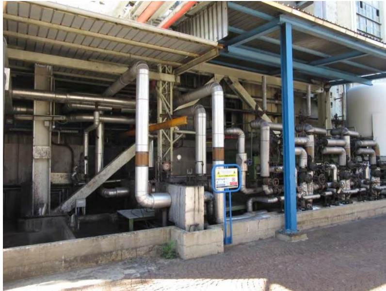
Figura 5: tettoia riscaldatori con relativo bacino di contenimento
