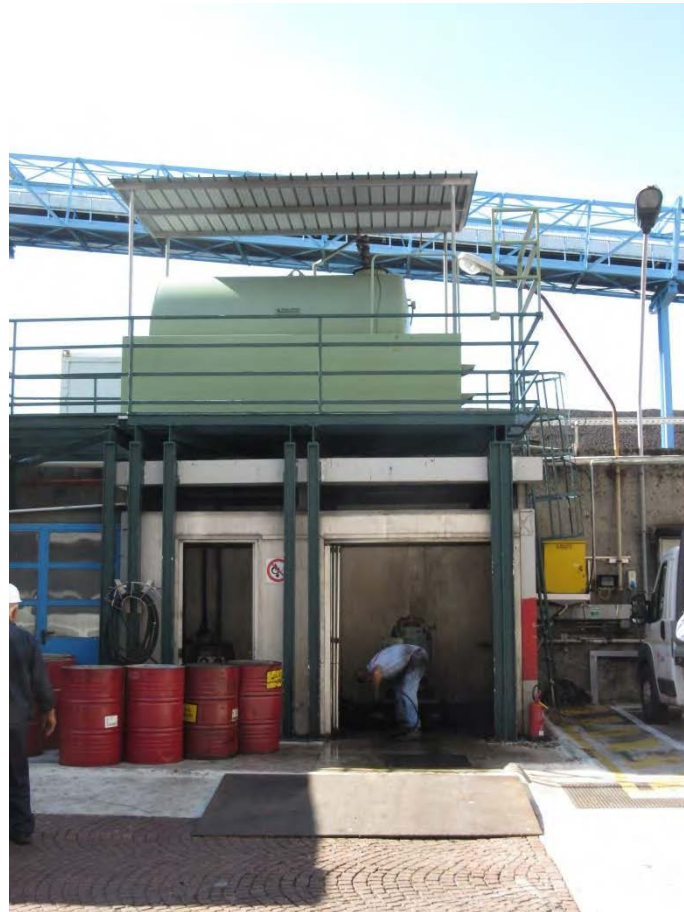
Figura 8: cabina lavaggio pezzi e serbatoio gasolio da riscaldamento
