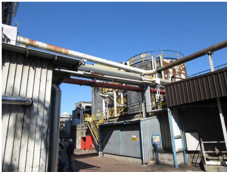
Figura 6: tubazioni fuori terra per il trasferimento del combustibile
